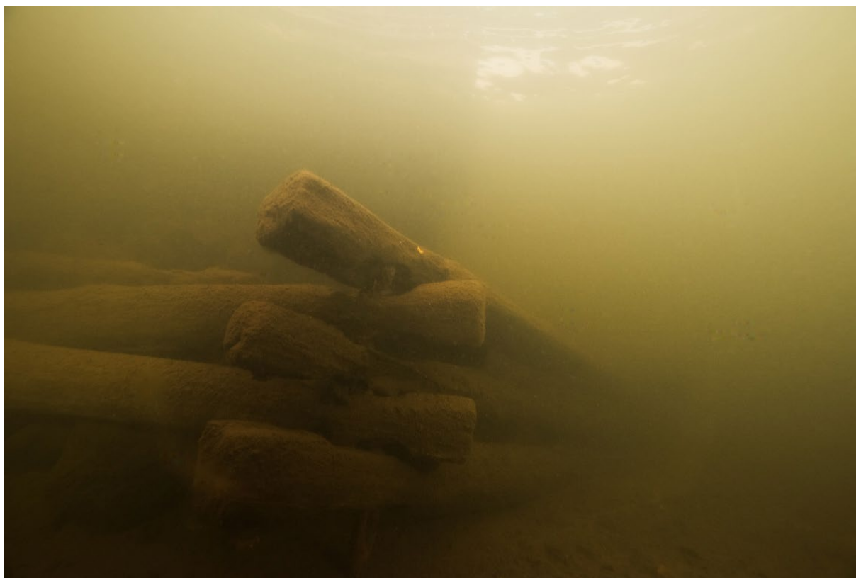
Figur 25. Nedre delen av en av stenkistorna, konstruktion B, som anlagts under slottets tid. Foto taget under dykning 8 november 2016.
