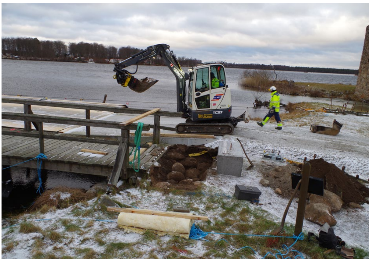
Figur 37. Schakt 2 togs upp vid brofästet på Stallholmens nordvästra del. I schaktet syns den sentida stenläggning som fanns överst i schaktet. Foto taget från nordöst.
