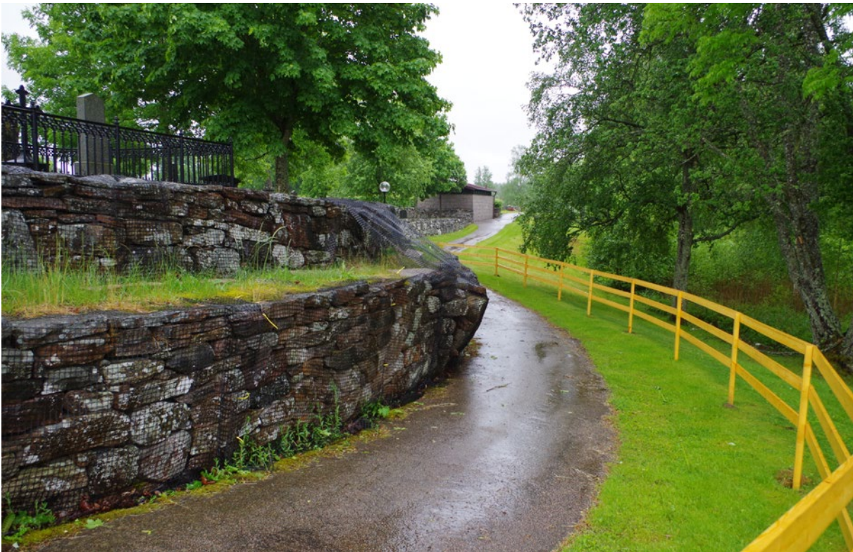
Figur 10. Rundeln i den västra kyrkogårdsmuren med utrasat parti. Foto taget innan reparationsarbetet påbörjade. Till höger i bild syns den låga marken ned mot vattendraget väster om kyrkan. Foto från norr.
