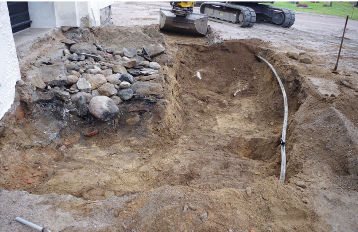
Figur 6. Pågående schaktarbete runt kyrkans trappa. Det större stengrundslager (K1201) vilket framkom söder om, och troligen under, kyrkan, börjar framträda i schaktets botten del. Foto från N.
