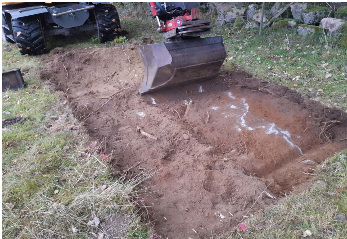
Figur 3. Schaktningen genomfördes skiktvis. På fotot togs ytan upp för infiltrationen. Foto från öster.
