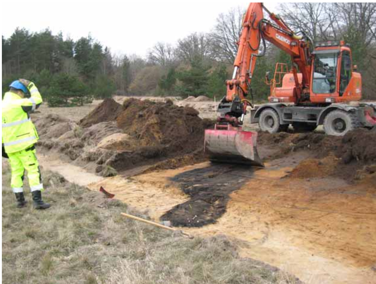
Figur 9. Magnus Petersson schaktar fram den långsmala förmodade härden A50 i delområde 1. Foto från NO Ludvig Papmehl-Dufay/Kalmar läns museum.
