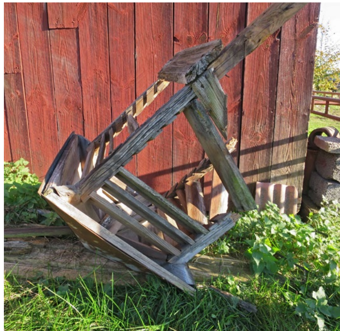
Befintlig ventilationshuv före renovering. Den befintliga huven är nedmonterad för en närmare undersökning.
