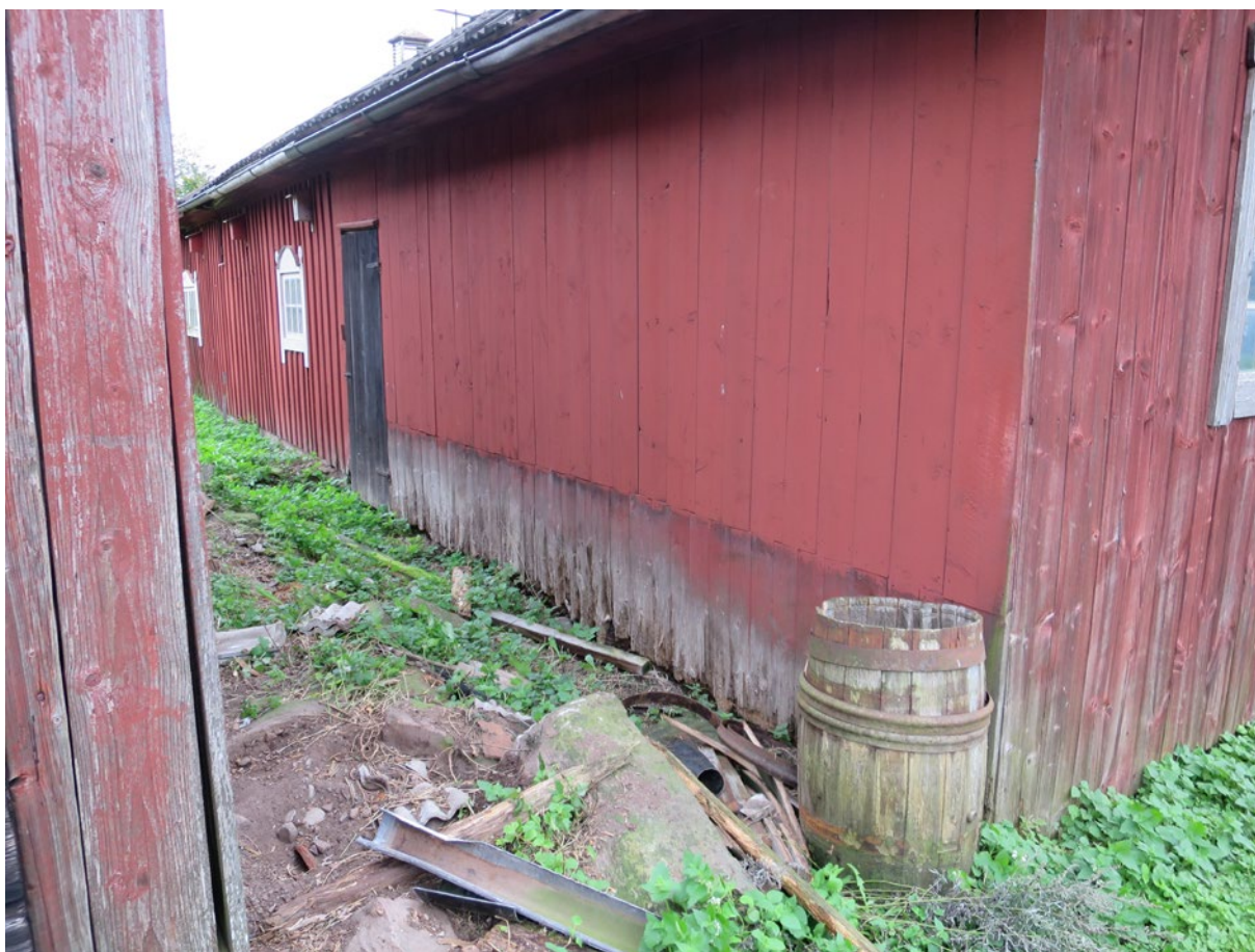
Norra fasaden före åtgärd. Här syns den raka skarven efter ett tidigare byte av panelen åt väster.
