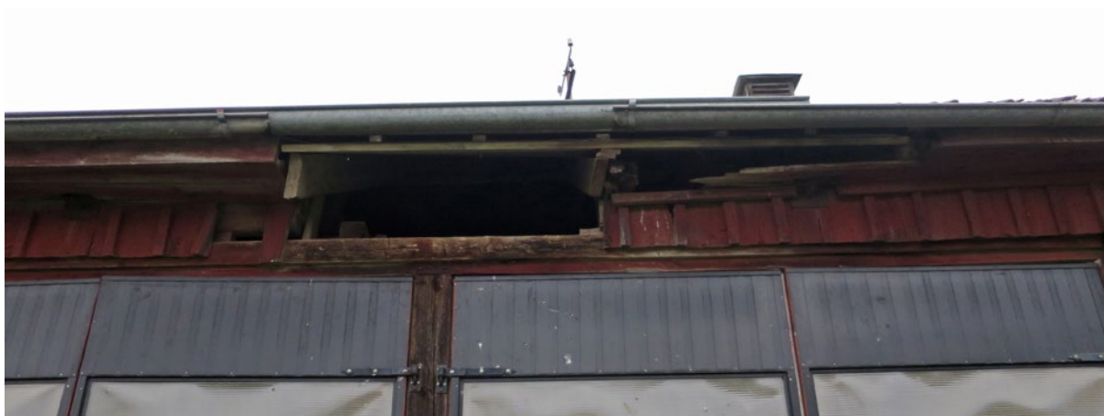
Södra takfallet före renovering. Här syns den tidigare taklagningen och takstolsförstärkingen. Notera hur takstolsförstärkingen sticker ut och saknar inklädnad.
