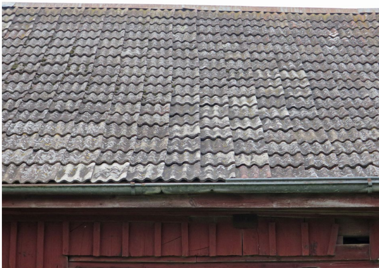
Södra takfallet före renovering. Här syns att den röda kulören på pannorna är helt borta.
