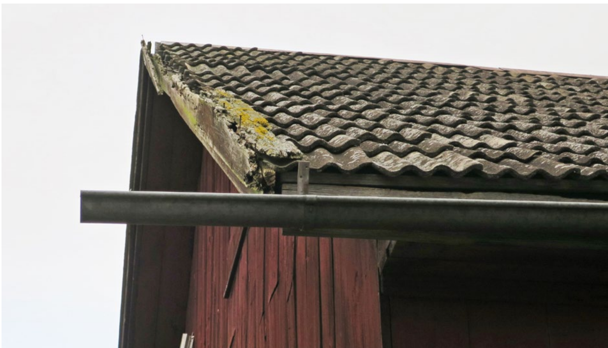
Södra takfallet före renovering. Stormlisten har nästan fallit bort helt och den övre vindskivan är kraftigt röt-skadad.
