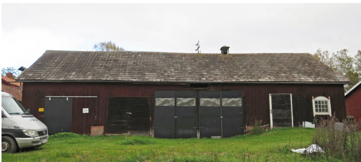
Södra takfallet före renovering. Notera de gamla hängränorna längs takfoten.
