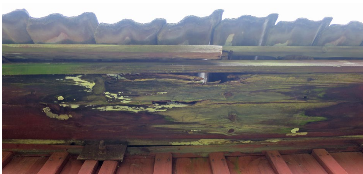
Norra takfallet före renovering. En av rötskadorna på takfoten.
