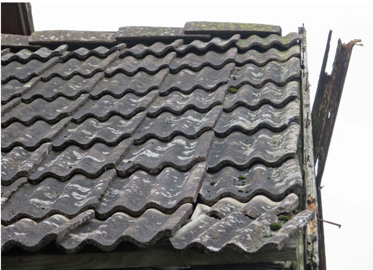
Tillbyggnadens norra takfall före renovering. Här syns det hur betongpannorna har glidit ur position. Notera också nockpannorna i betong.
