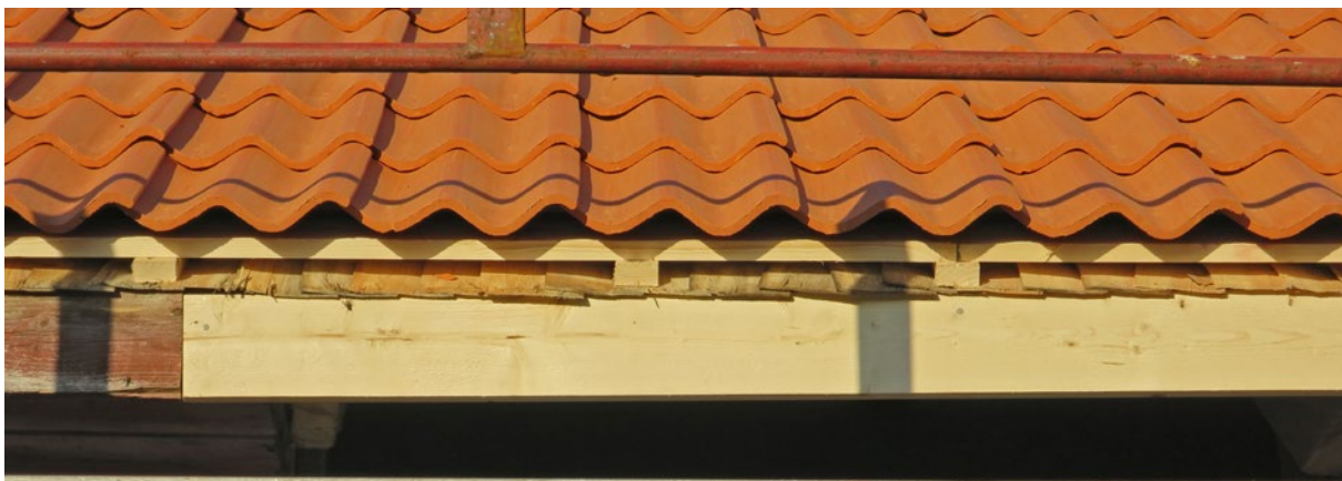
Södra takfallet under pågående renovering. Här har den tidigare taklagningen med masonit fått ett lager stickespån i nederkant. De tidigare utskjutande takstolsförstärkningarna är tillsågade och inbyggda likt resten av takfoten.
