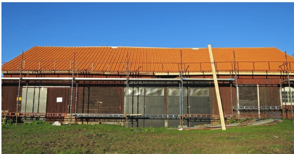
Södra takfallet under pågående renovering. Här är de nya tvåkupiga tegelpannorna lagda. Nockpannor och ventilationshuvor saknas ännu.
