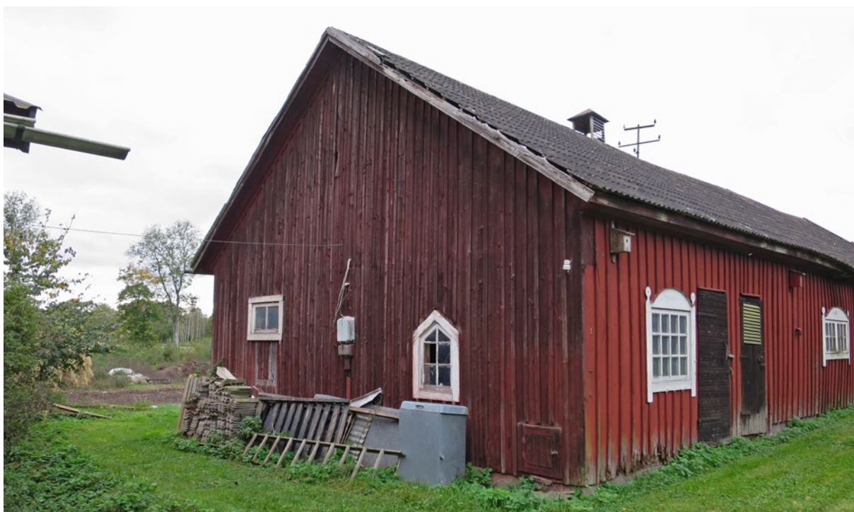
Norra takfallet före renovering. Stormlisten och den övre vindskivan har nästan fallit bort helt.
