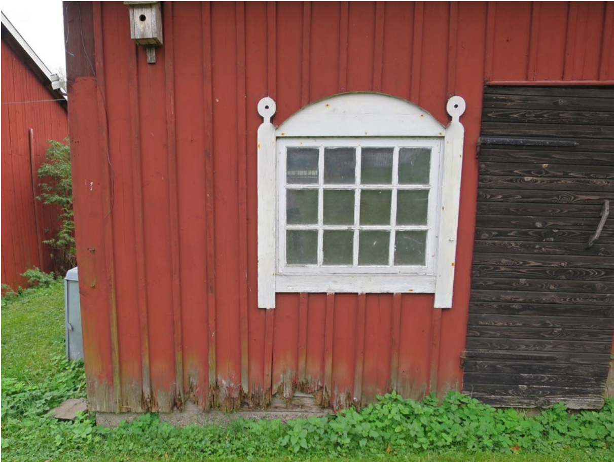
Norra fasaden före åtgärd. Här syns hur nedre delen av panelen åt öster har rötskador.
