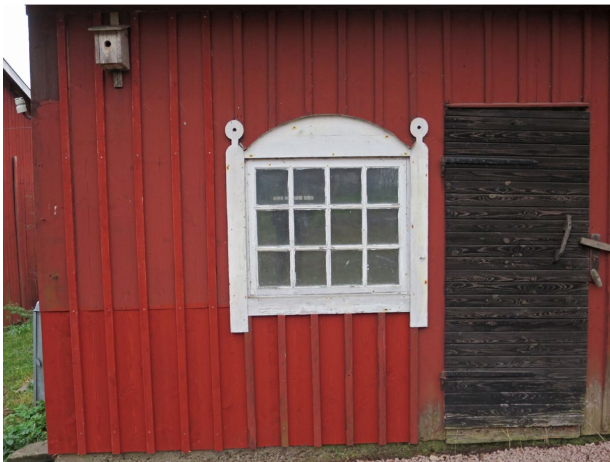
Norra fasaden efter åtgärd. Här har den tidigare rötskadan åt öster lagats med en rak skarv.
