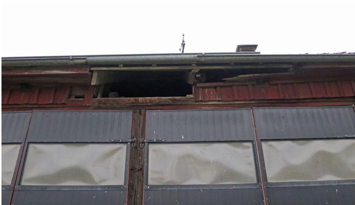
Södra fasaden före åtgärd. Här fattas panel efter den tidigare utförda lagningen och förstärkningen av taket.
