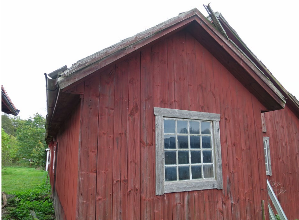
Tillbyggnaden före renovering. Stormlisterna och de övre vindsnivåerna är skadade även här, men är ändå i något bättre skick än på ladugården.
