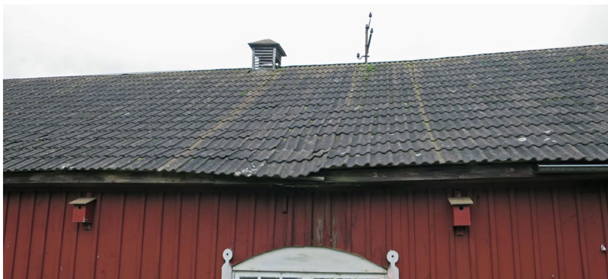
Norra takfallet före renovering. Här syns det hur betongpannorna har glidit ur position.
