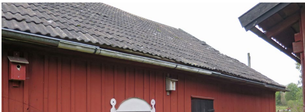
Norra takfallets hängrännor före renovering.
