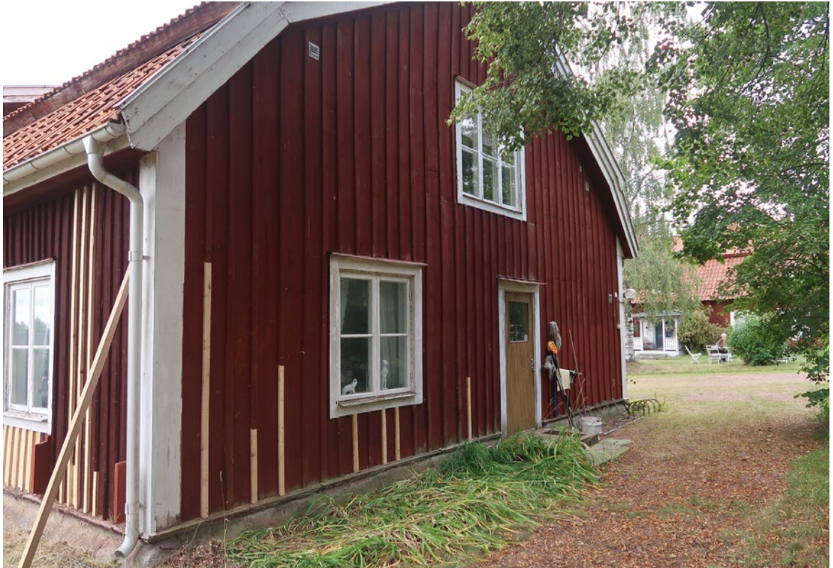
Tingshusets nordöstra fasad under pågående åtgärd. Ett fåtal dåliga partier av locklisten har bytts ut. Foto: Jan Westergren.
