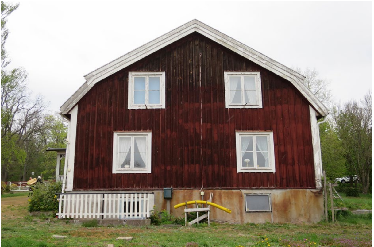
Tingshusets sydvästra fasad före åtgärd. Fasaden är flammig och högst upp inock är i princip all rödfärg borta. Vindskivornas färg flagar.
