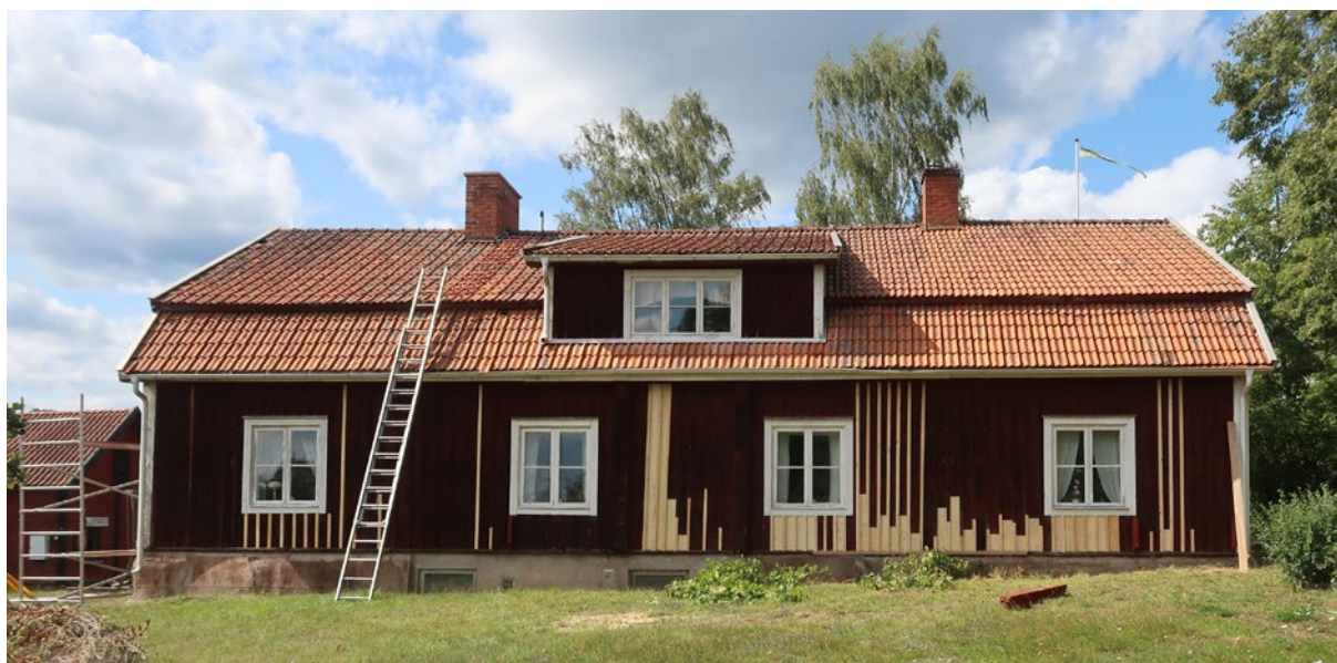
Tingshusets sydöstra fasad under pågående åtgärd. Här har en del lagningar gjorts både på locklistpanelen, dropplisten och på nedre delen av ett foder. Foto: Jan Westergren.
