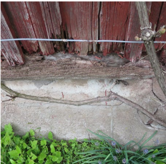
Tingshuset före åtgärd. Exempel på skador i panelens nedre del och på dropplisten.
