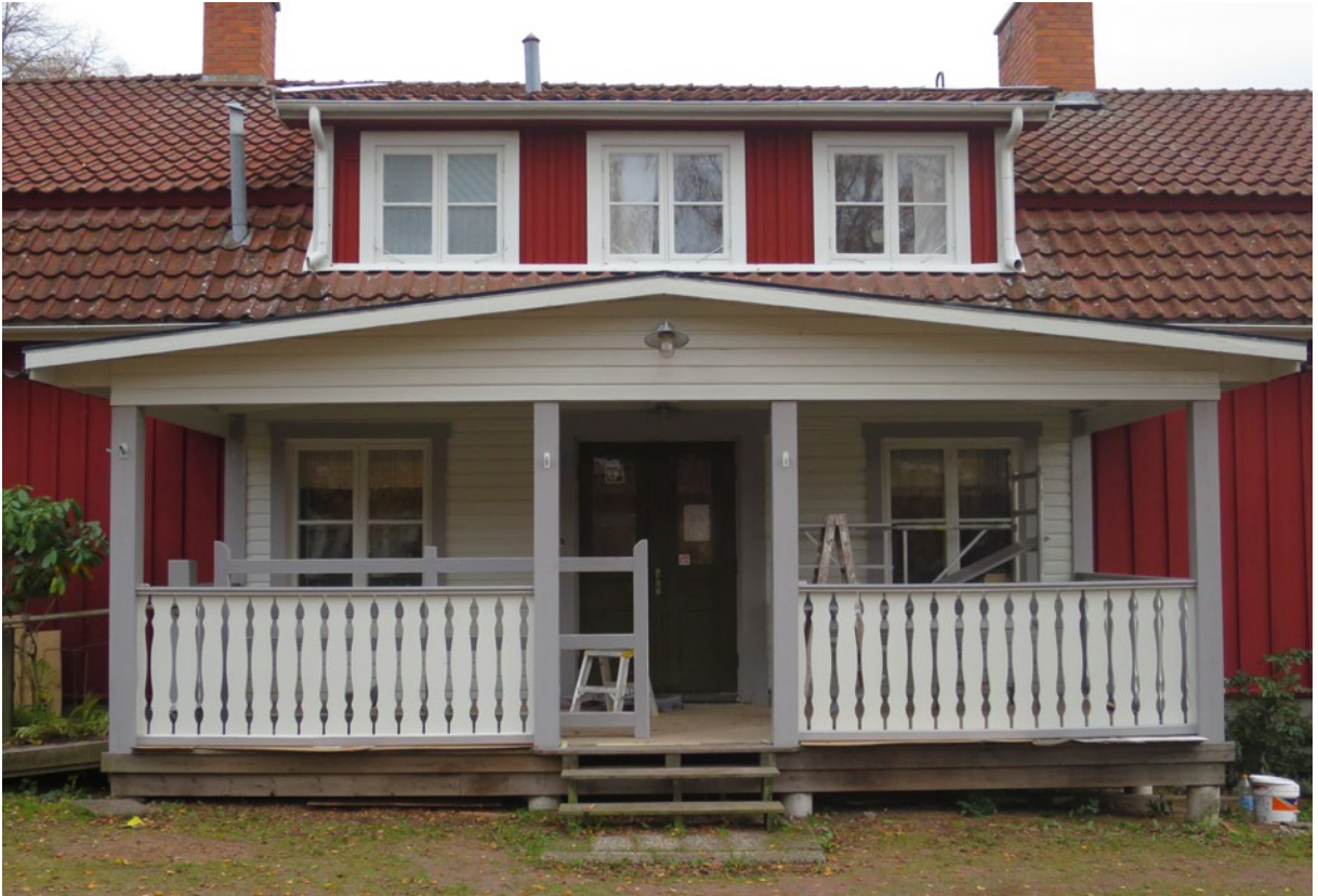
Tingshusets veranda efter åtgärd. Hela verandan skulle vid fototillfället strykas en gång till och därefter skulle snickarglädjen, som fattas på fotot, monteras.
