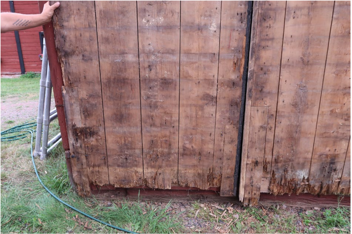
Delar av de nordvästra portarnas nedre delar, som uppvisade skador. Här behövde delar av de nedre delarna, samt ytterkanter, bytas. Foto: Jan Westergren.
