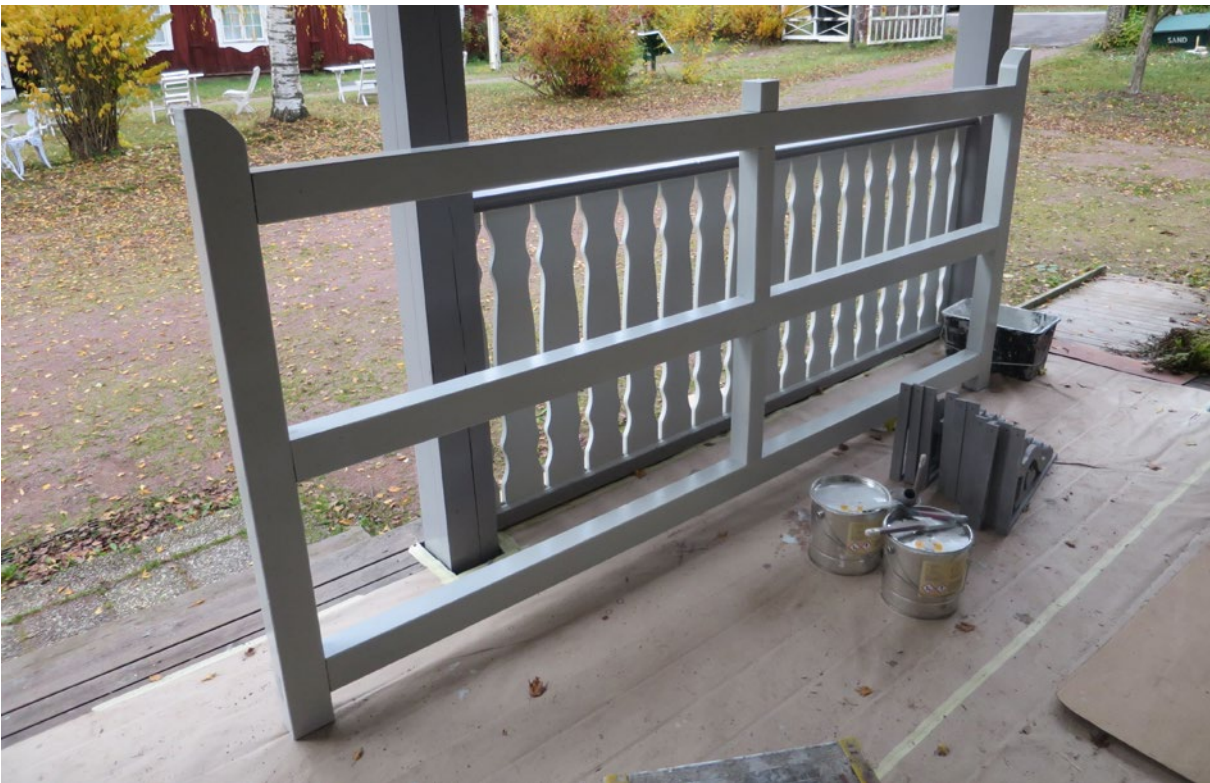
Grinden efter åtgärd. Det återstår ett par strykningar med linoljefärg samt kryssen i de nedre och övre partierna. Dessa monteras i samband med att grinden sätts på plats. På fotot är grinden grundmålad i en grå kulör men den kommer målas vit.
