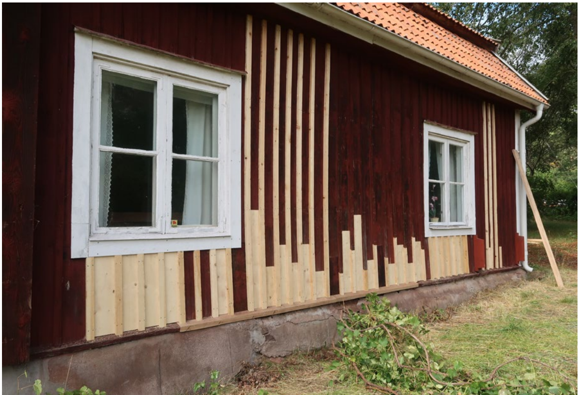
Del av sydöstra fasaden. Här ser man den del av dropplisten som bytts ut. Foto: Jan Westergren.
