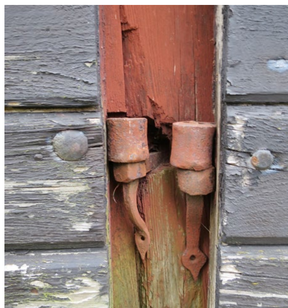
Detaljbild på gångjärnen till portarna före åtgärd.
