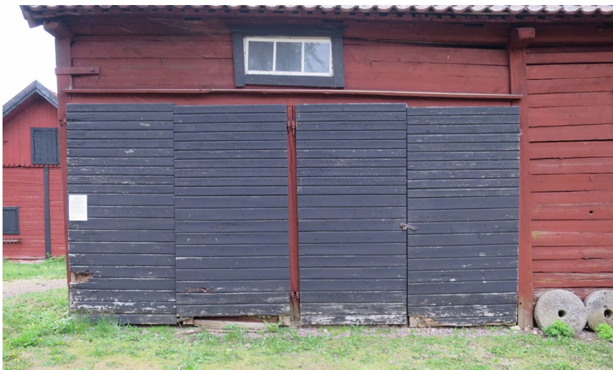
Portarna på vagnsboden före åtgärd.
