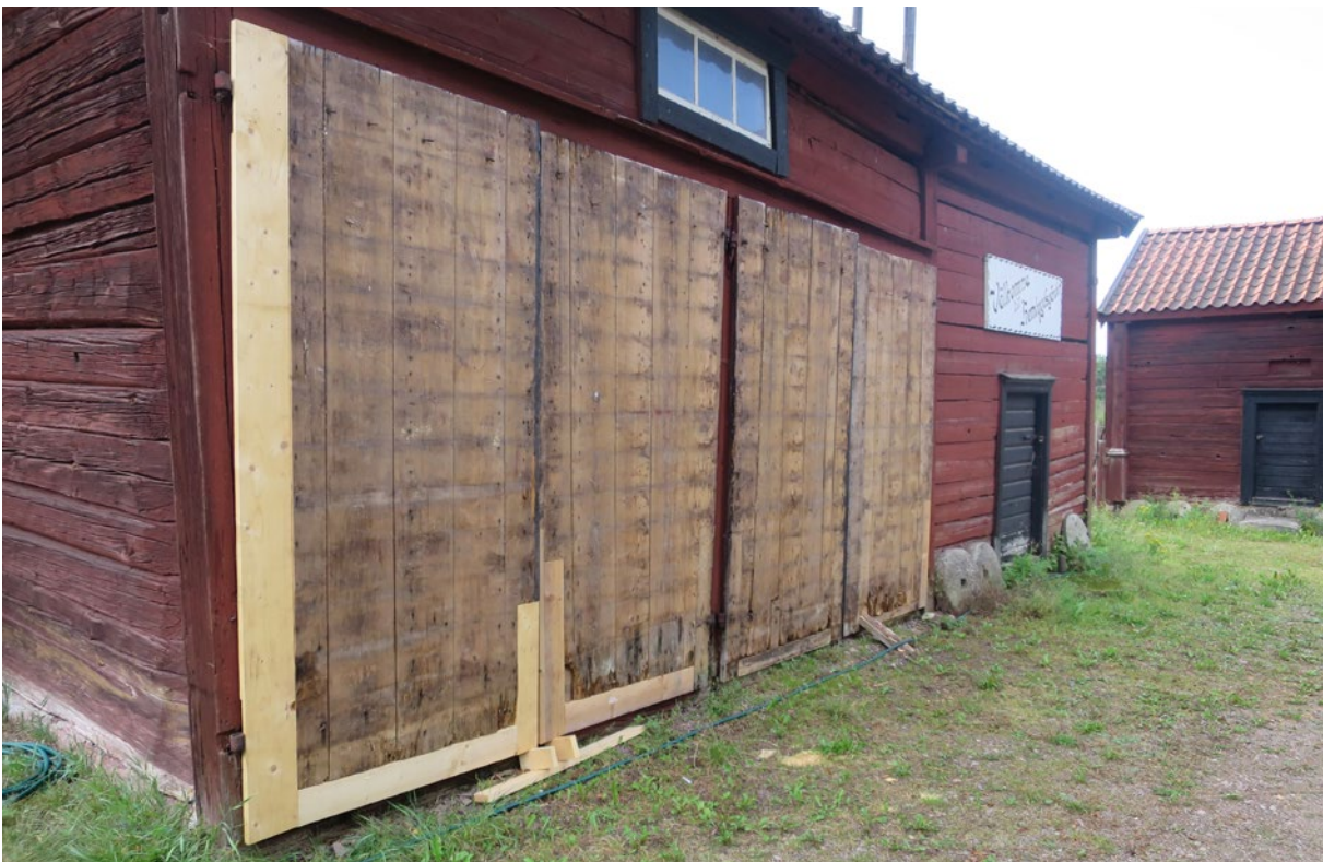
Portarna efter att dåliga delar i konstruktionen bytts ut. Foto: Jan Westergren.
