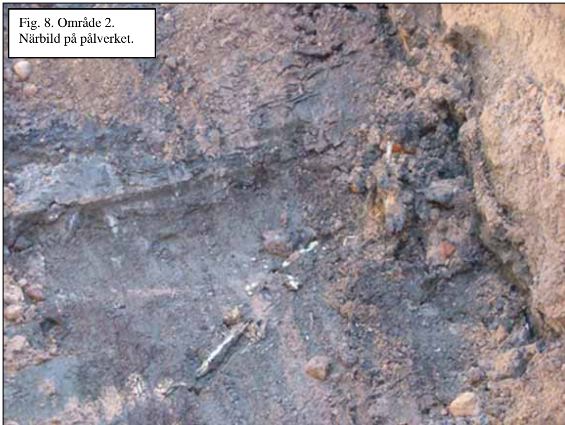
Fig. 9. Område 2. Det kollap- sade schaktet. I schaktets mitt låg pålverket. Till höger i bild ses hur labil marken var, en stor spricka löper längs med hela schaktet.
