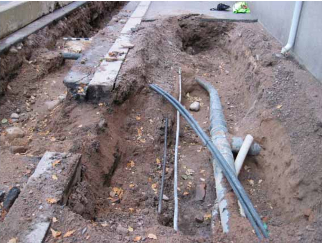
Bild 3. Mylla av ledningar i under trottoaren.
