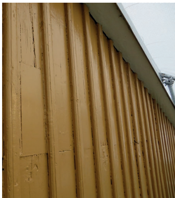
Lagningar har gjorts i fasaden mot Södra Vallgatan, övre parti.
