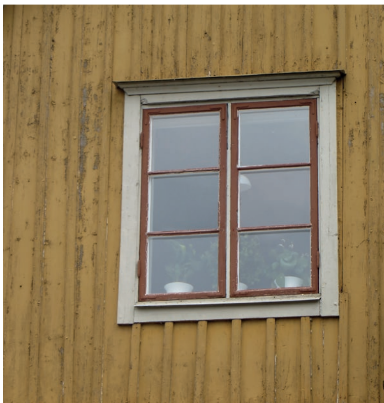
Närbild av fasad och fönster i behov av renovering.
