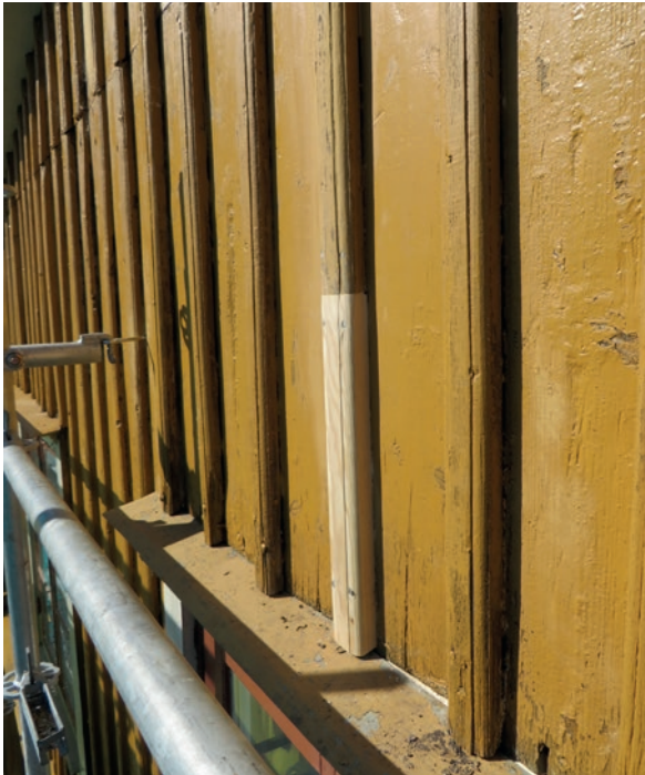
Exempel på utbytt del av locklist inför målning. Fasad mot Södra Vallgatan.
