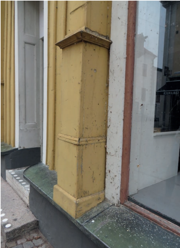
Knutlåda Kaggensgatan, inför åtgärd.
