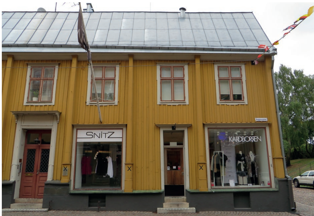
Fasad mot Kaggensgatan inför åtgärder. X-markeringar visar var delar av knutlådor byttes ut.
