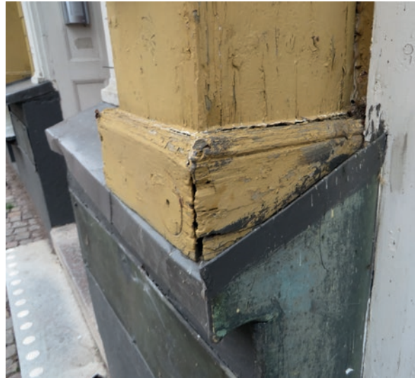
Detalj knutlåda Kaggensgatan, inför åtgärd.
