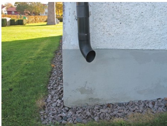
Närbild av sakristians ytterhörn i nordväst före åtgärd. Stuprör och utkastare i fabrikslackerad svart plåt.
