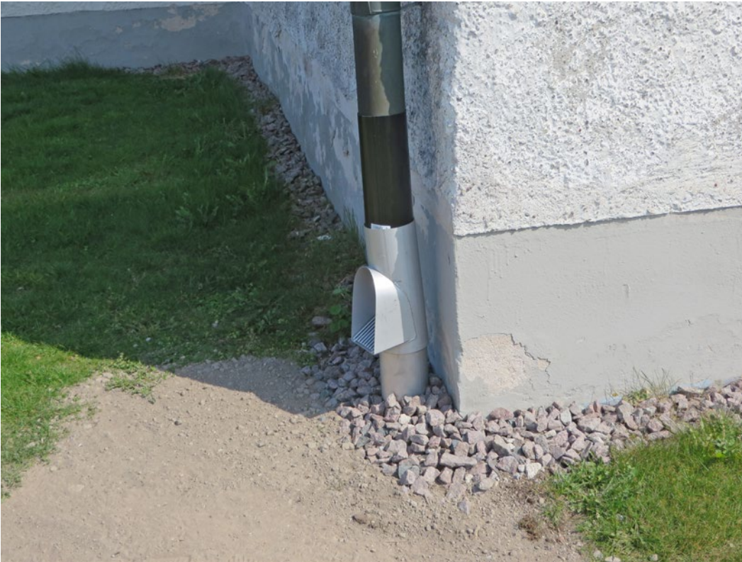
Tornets nordvästra hörn. Kyrkans befintliga stuprör har försetts med lövrensare och anslutits till ett nedgrävt system för tillvaratagande av dagvatten från taken.
