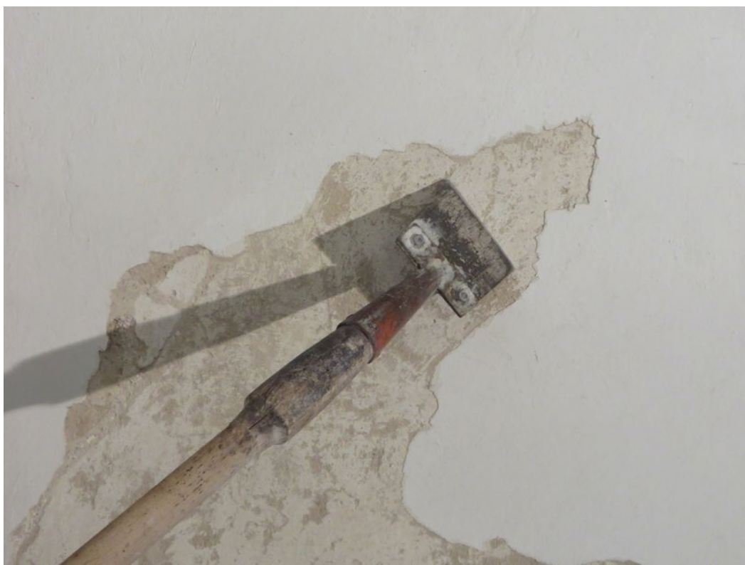
Det yttersta tunna putsskiktet satt löst och kunde lätt skrapas bort.
