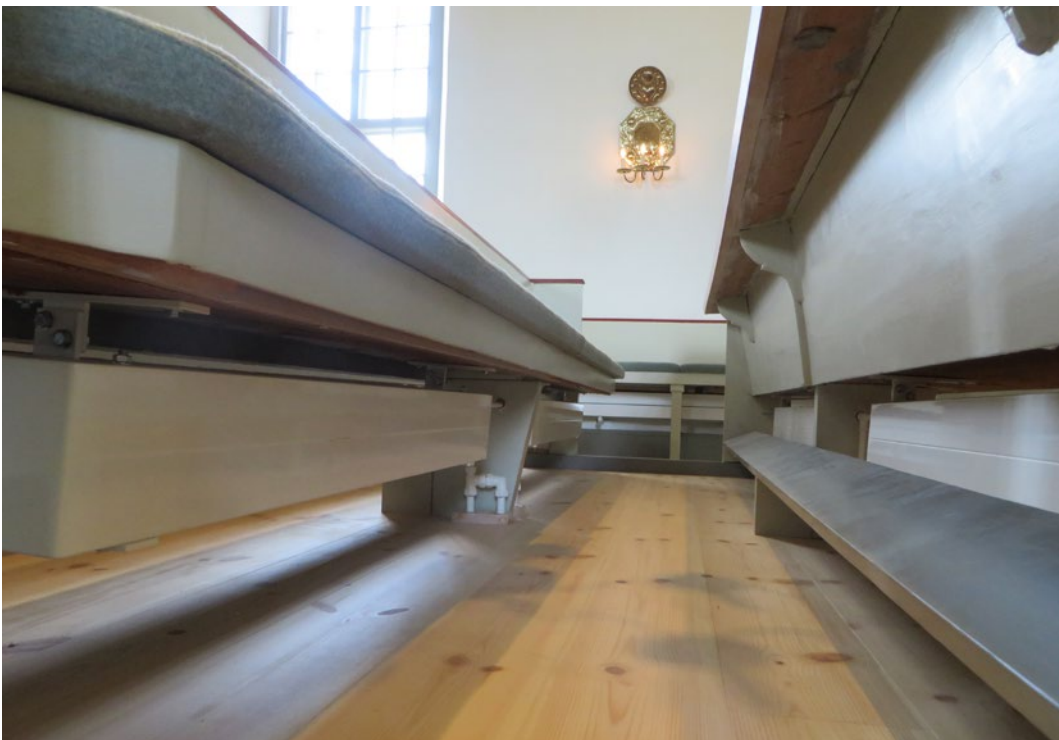
Nya bänkvärmare av typen Watt Heating kyrkbänskonvektorer har monterats under samtliga bänkar. Hur de nya släta panelradiatorerna ser ut syns bland annat på de bilder som visar sakristians nya textilförvarings-skåp.
