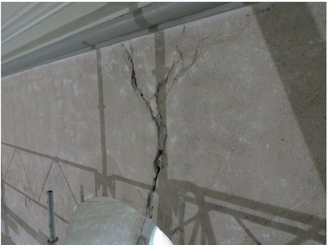
Äldre sättningskada över fönster mot norr.
