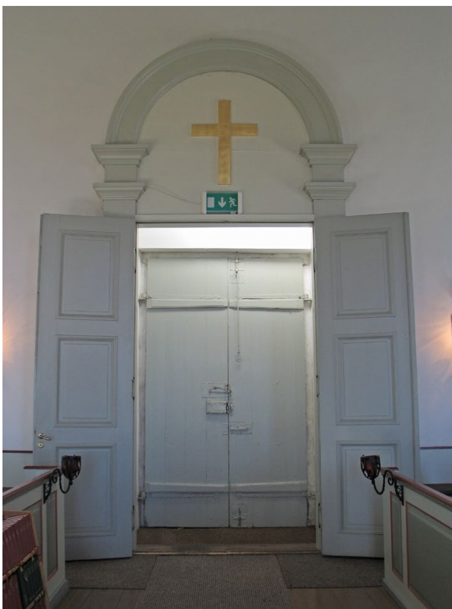
Södra entrén före montering av dörröppnare. De yttre dörrbladen är från 1841 och de inre från början av 1930-talet.
