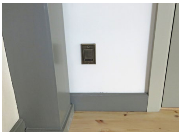
Anslutningar till centraldammsugare infällda i golvet vid bänkkvarter och på vägg mot HWC.
