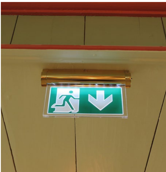
Utrymningsskylt under läktare.
