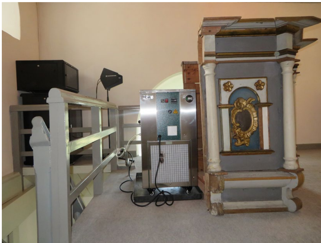
Luftfuktigheten hålls under 60% RH med hjälp av två luftavfuktare. Här syns den större sorptionsavfuktare som är placerad vid läktarens norra sida.
