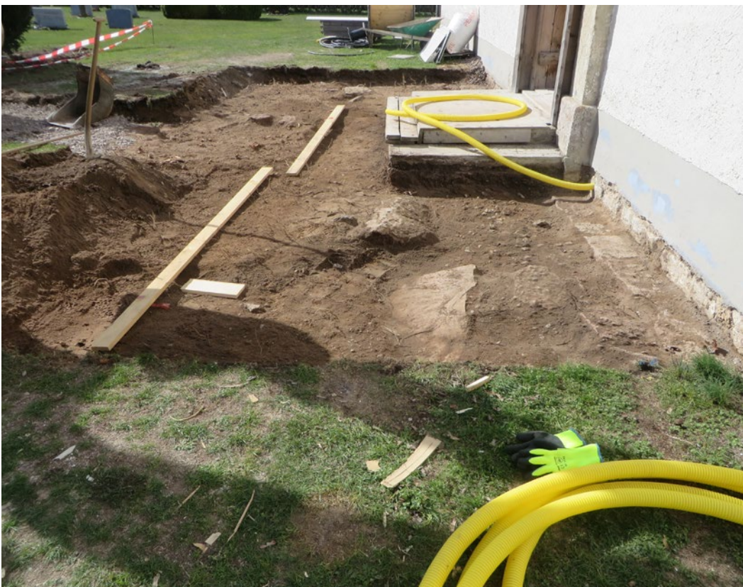
Schaktet framför kyrkans södra entré fotograferat från öster. De ytor av kalkbruk som upptäcktes har markerats med brädor på marken.
