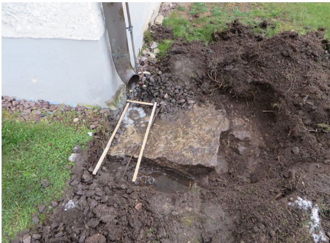
Frilagd hörnsten vid tornets nordvästra hörn. För att kunna dra fram de nya dagvattenledningarna till anslutningen under stuprören sågades ett smalt urtag i stenen. På bilden har en tumstock lagts där snitten skulle sågas. Tornets befintliga stuprör är av kopparplåt.
