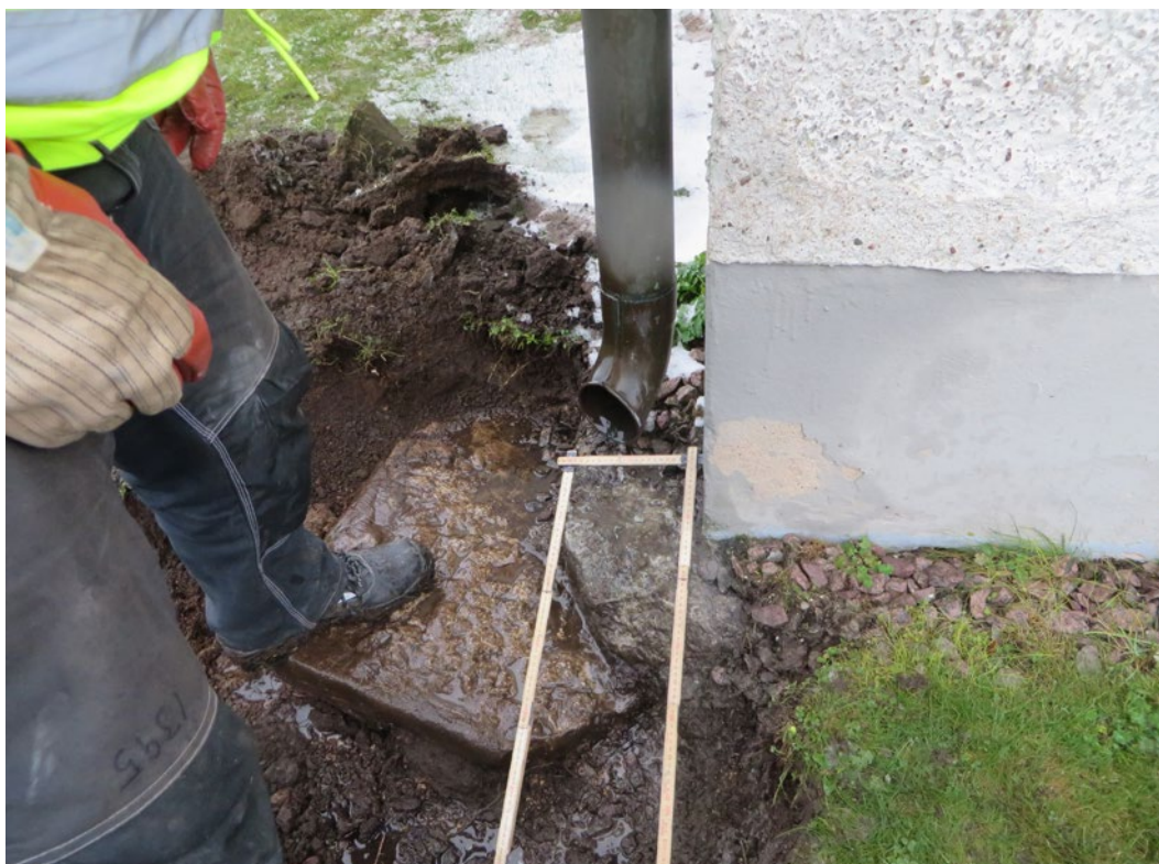
Markering av urtag för anslutning av ny ledning vid tornets hörn mot sydväst. Kyrkans medeltida torn hade något större yttermått än det nuvarande tornet från 1841. Eventuellt har hörnstenarna från det medeltida tornet bevarats i ursprungligt läge.
