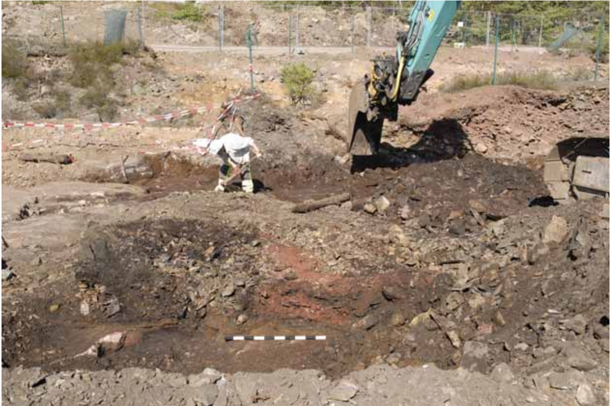
Fig 88. I förgrunden syns den skadade rosten Ho153 i vy från S. Foto: V Palm, KLM/VM.
