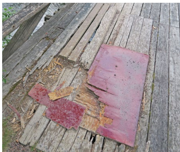
Körbanan före renovering. Provisoriskt lagade hål efter fordon som kört igenom den ruttna körbanan.
