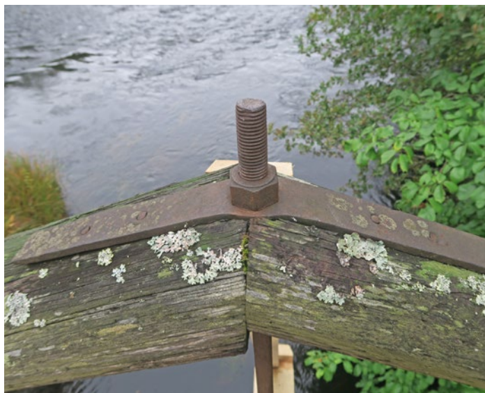
Bärlina och snedsträva efter renovering. Detaljbild på järnbrickan och muttern som förankrar räcket i den underliggande bärlinan. Foto: Ellen Olsson.
