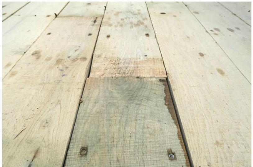
Körbanan efter renowing. Nedhyvlad skarv mellan två ekplank på körbanan. Foto: Ellen Olsson.
