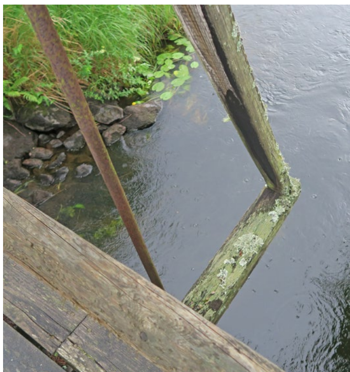
Bärlina och snedsträva före reovering. Mosspåväxt och röta gör att snedsträvan och bärlinan har svårigheter att hålla det stora broräcket på plats.
