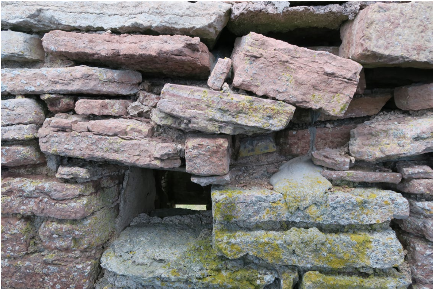
Nya kungshuset, fasad mot väster före renovering. År 1963 förstärktes grunden och delar av byggnaden med sprutbetong. I mitten av bilden återfinns sprutbetong som runnit ut mellan stenarna. Stenarna ser ut att vara helt instabila men är i själva verket helt fixerade.
