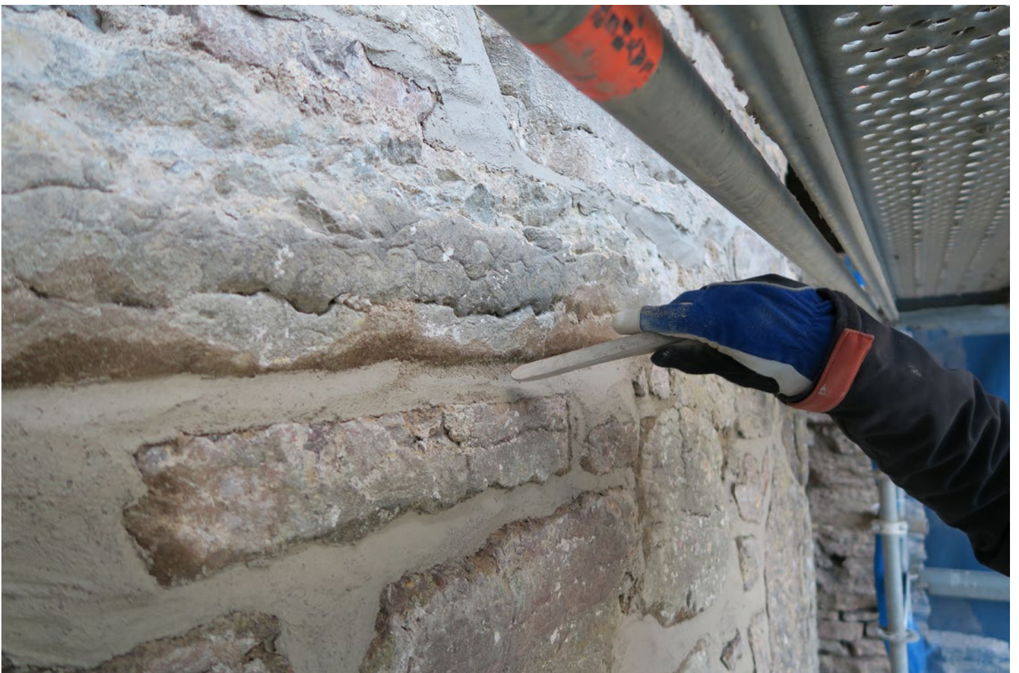
Efter det att man fogat muren med kalkbruket så återkommer muraren efter 4 till 6 timmar och eftertrycker fogen för att säkra en bra tätning mot stenen.
