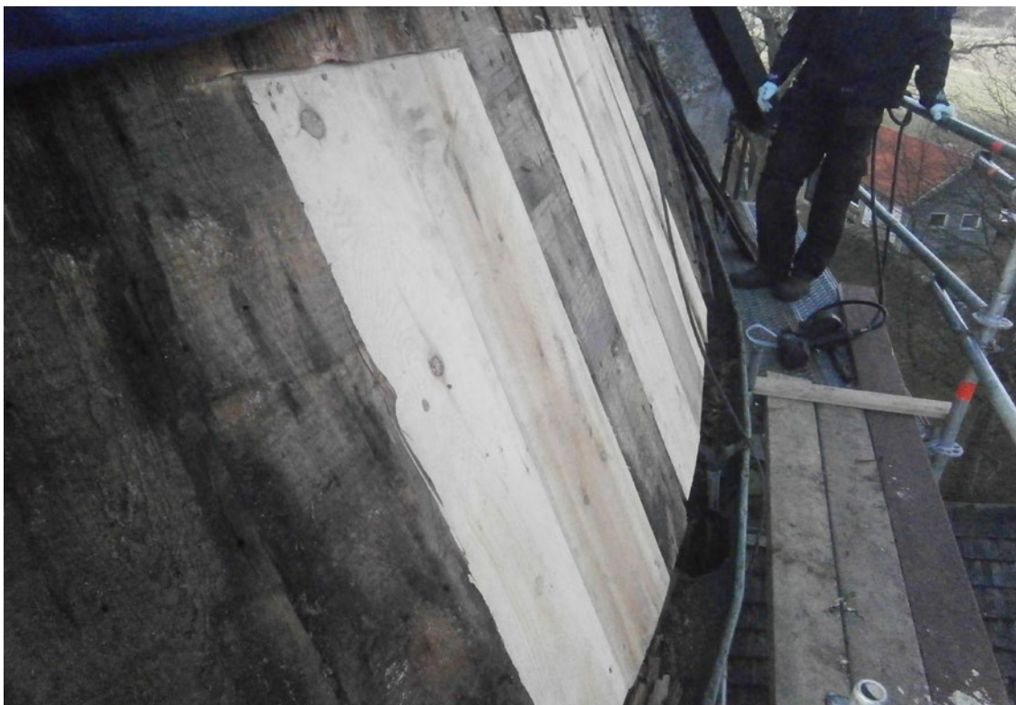
Skadade delar av korets svall nära takfoten mot norr har bytts ut. Foto: Hälsinge takspån.
