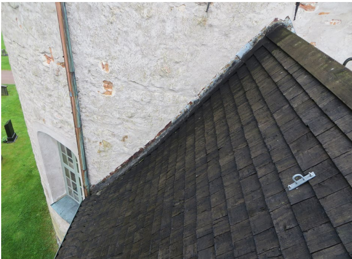
Närbild av sakristians östra takfall före renovering. Avtäckningsplåtarna vid mötet mot långhusets norra vägg var rostiga.
