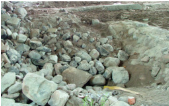
Fig 8. Först fylldes sand i botten av schaktet sedan sten för att stadga upp muren.
