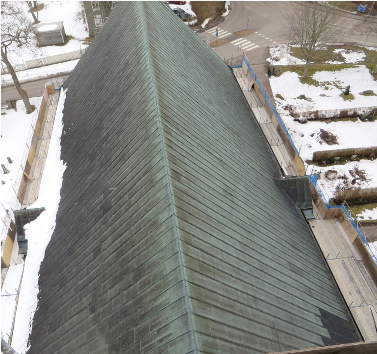
Långhustaket före åtgärd.
