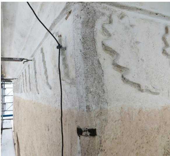
Tornet före åtgärd. Även eklövsfrisen var smutsig och missfärgad. I hörnen fanns generellt skador där putsen hade släppt.
