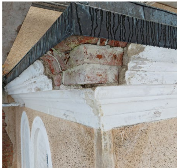
Koret före åtgärd. Skador på kortillbyggnaden mot norr.
