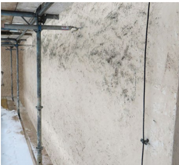
Tornet före åtgärd. Del av tornets norra sida, där delar av spritputsens är smutsig och missfärgad.
