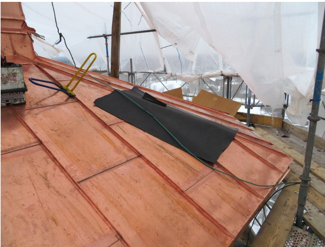
Delar av lanternintaket under pågående åtgärd. Ny kopparplåt har lagts på delar av lanternintaket.
