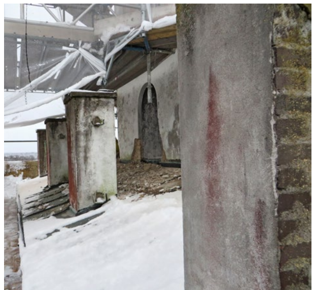
Lanterninen före åtgärd. Stolparna kring lanterninen var putsade med KC-bruk och hade fler skador och putsbortfall.
