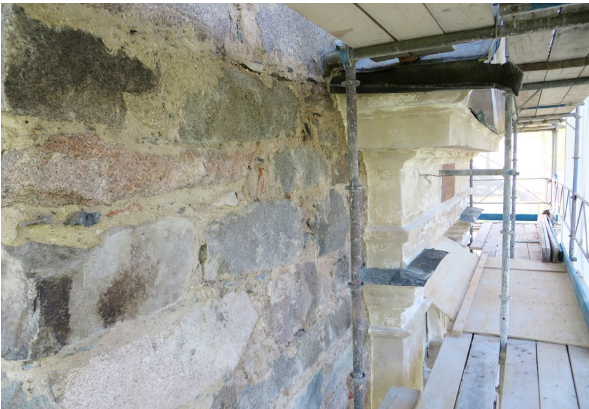
Tornet under pågående åtgärd. Större delen av den putsade portalen kring porten mot väster kunde sparas.
