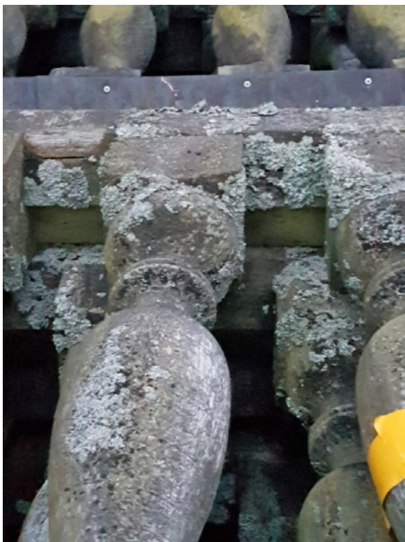
Delar av lanterninracket före åtgärd. Foto: Staffan Bergström.
