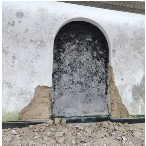
Lanterninen före åtgärd. Exempel på skador vid en av blindluckorna.
