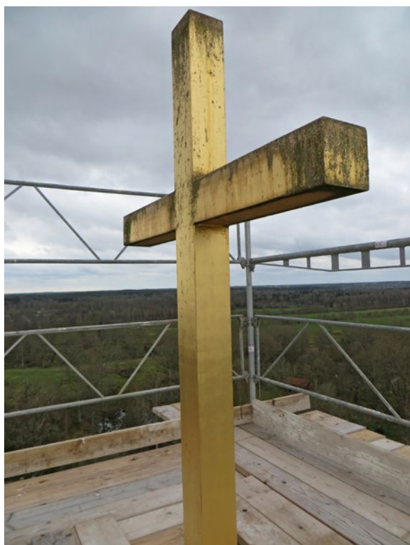
Korset på lanterninen före åtgärd.
