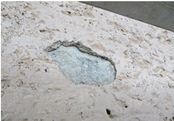
Tornet före åtgärd. Exempel på putsbortfall. Här ser man att putsen bitvis var mycket tunn.
