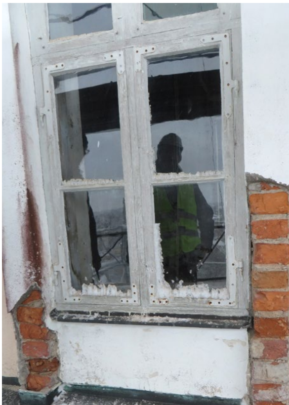
Ett av lanterninens korspostfönster före åtgärd.
