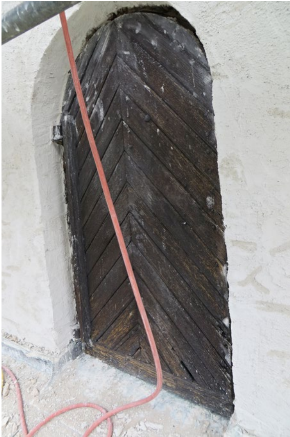
Lanterninens trädörr före åtgärd.
