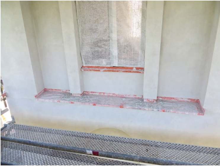
Lanterninen under pågående åtgärd. Fasaderna är här nyputsade och kan snart avfärgas.
