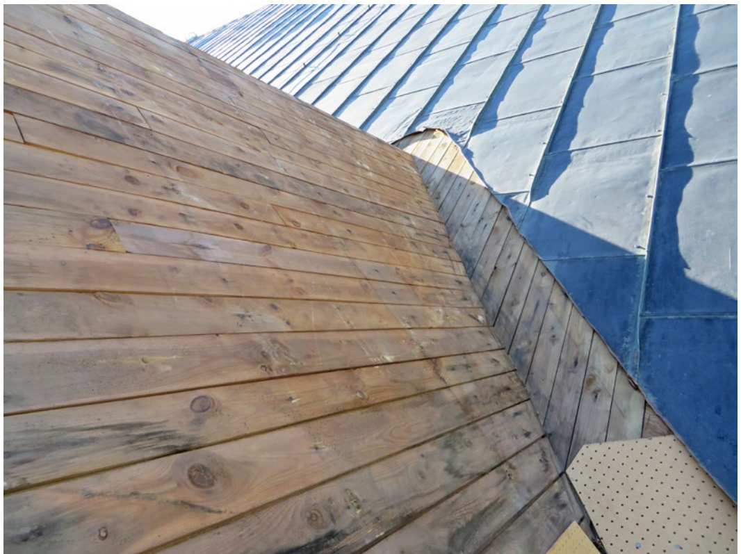
Mötet mellan sydportalens takfall och långhusets södra takfall. Här ser man att svallet ligger i fel riktning på långhuset.
