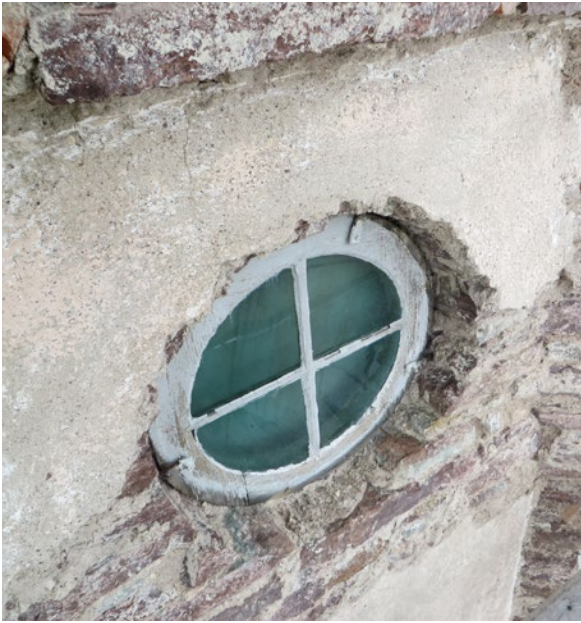
Ett av lanterninens små, runda fönster före åtgärd.
