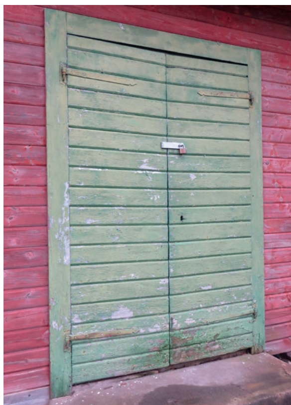
Pardörren på brygghuset före åtgärd.
