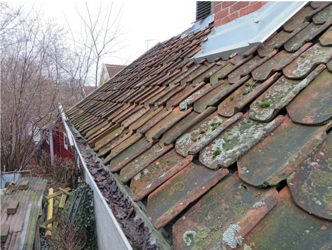
Del av det östra takfallet före åtgärd. Vissa pannor är spräckta och behöver ersättas.
