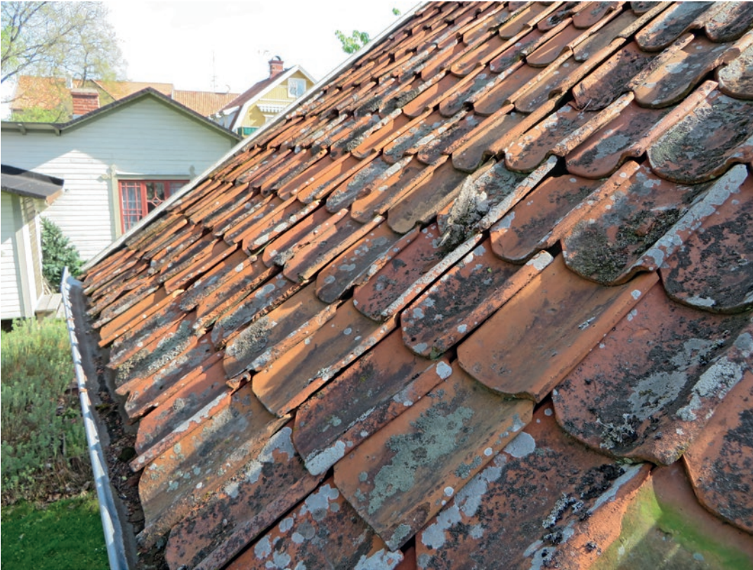
Del av västra takfallet före åtgärd. Vissa pannor är spräckta och behöver ersättas.
