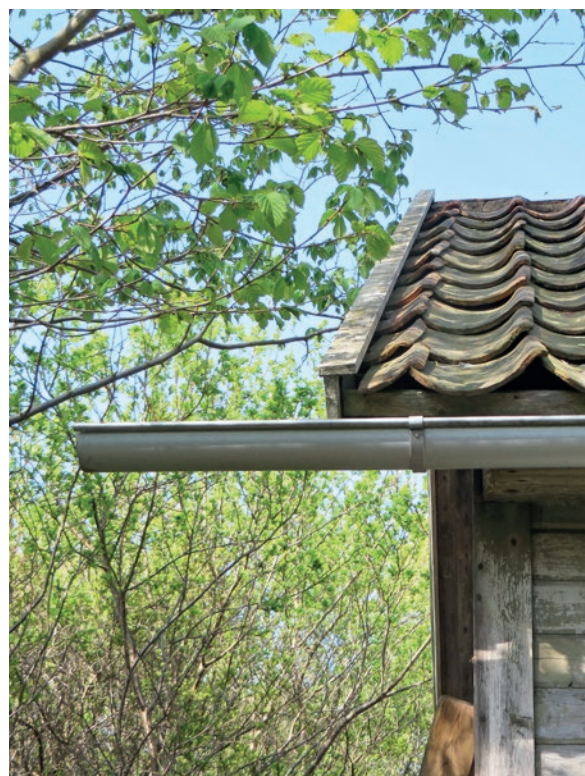
Den östra hängrännan, vid det sydöstra hörnet, före åtgärd. Hängrännan behöver förlängas så att nederbörd inte stänker upp på fasaden.
