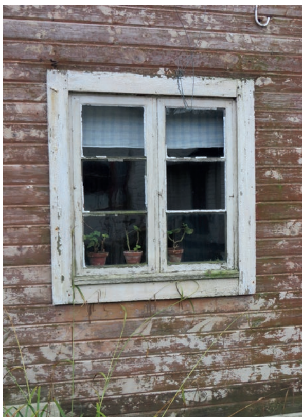
Ett av fönstren på brygghuset före åtgärd. Mycket utav kittet har fallit bort och färgen flagnar kraftigt.
