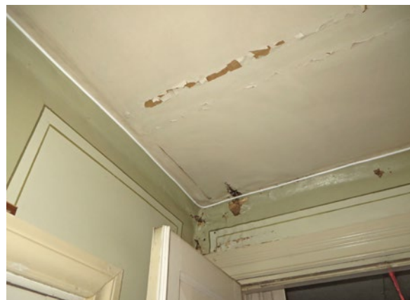
Närbild av skador i taket och på övre delen av väggarna i hallens sydvästra hörn.
