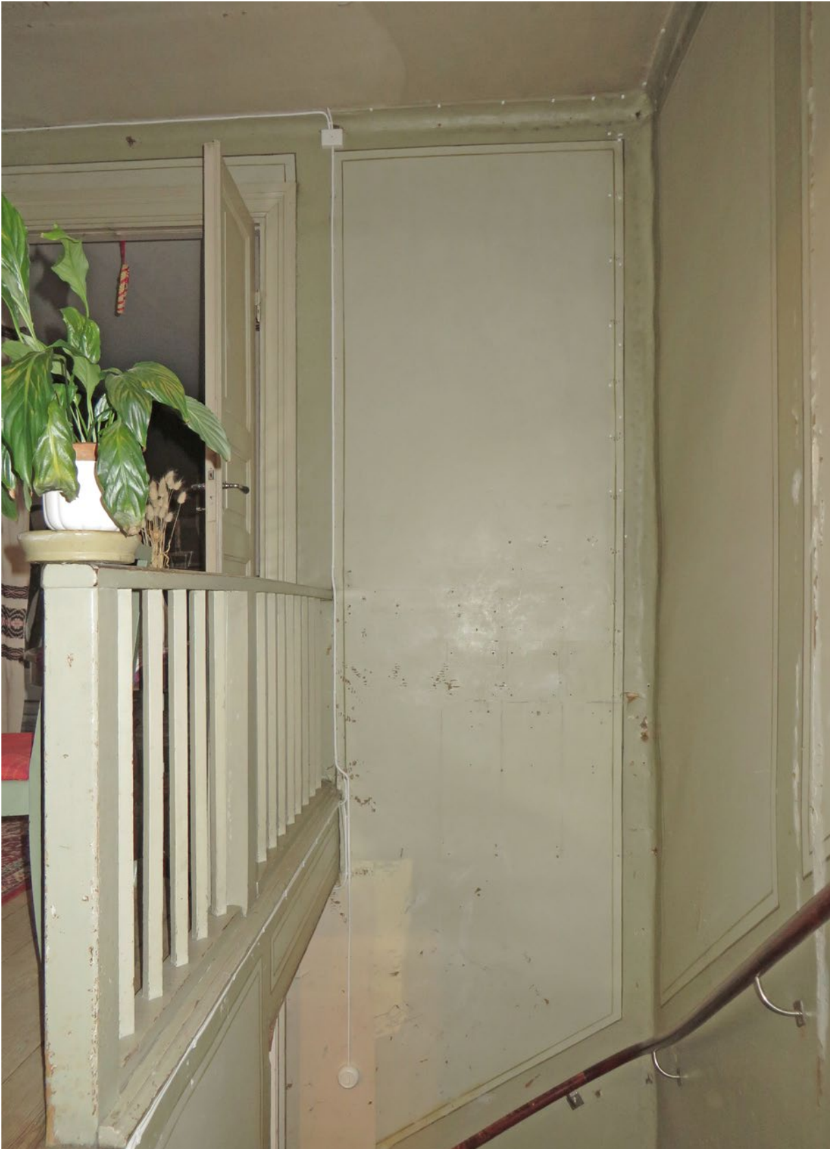
Övre hallen före lagning och ommålning av väggar och tak. Det fanns en stor mängd skador i ytskiktet.
