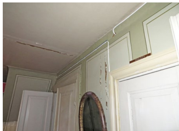
Hallens vägg mot toalett och sal före åtgärd. Fältindelningen kan ursprungligen ha tillkommit innan toaletten byggdes 1945, men har av de rollade ytorna att döma förnyats senare.
