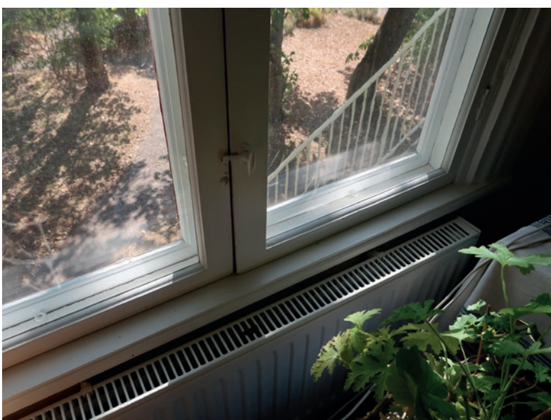
Samma fönster efter ommålning.
