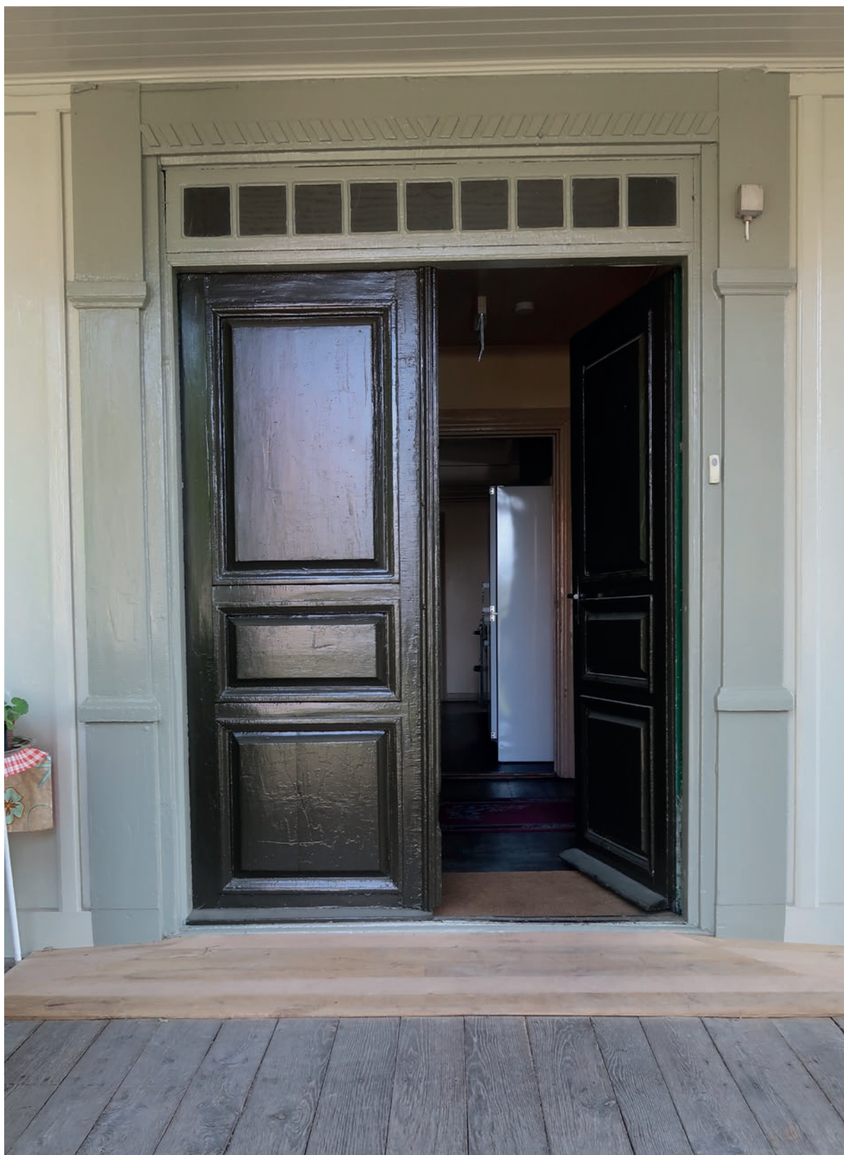
Huvudentrén efter ommålning. Dörrbladen målades med obruten grön umbra, kulörbeteckning 1A-30 enligt Riksantikvarieämbetets provsamling för linoljefärger.
