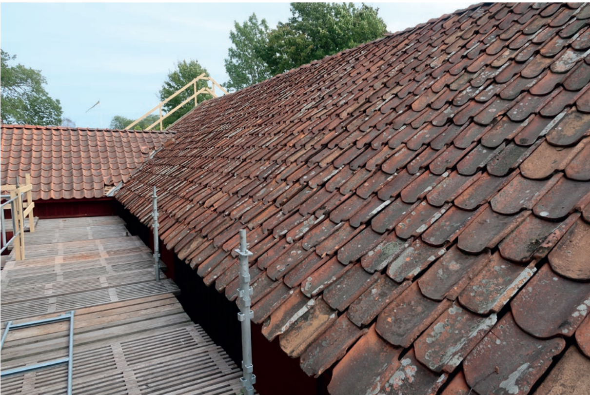
Närbild av det norra takfallet efter att byggställningar rests. Hela det norra takfallet var belagt med gamla handslagna tegelpannor. Längre bort i bild syns den lägre ladugårdsdelens västra takfall, med beläggning av maskintillverkade pannor.
