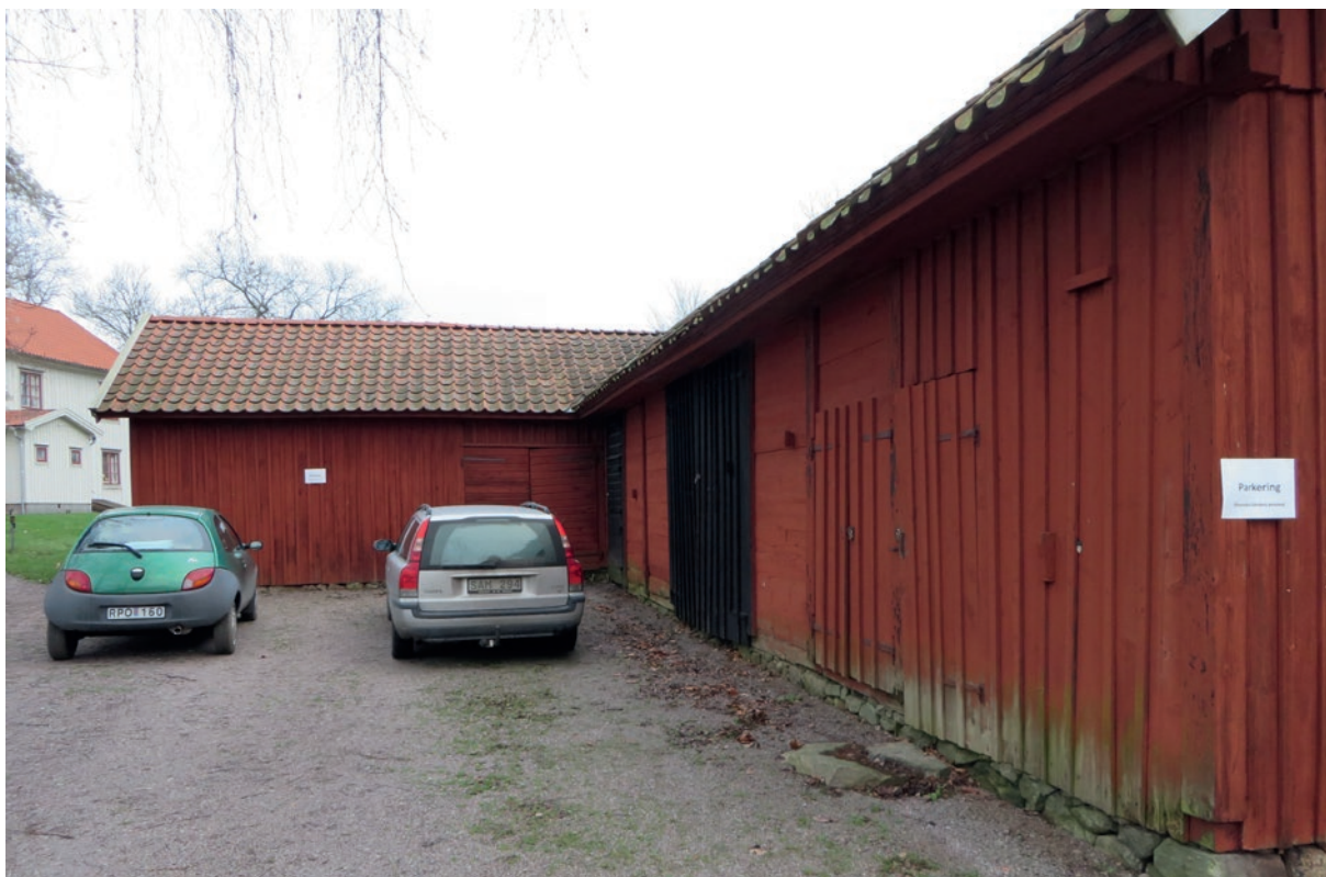
Ladugårdens norra fasad, till höger i bild, hade skadats i underkant på grund av att regnvatten från taket stänkt tillbaka upp på fasaden.
