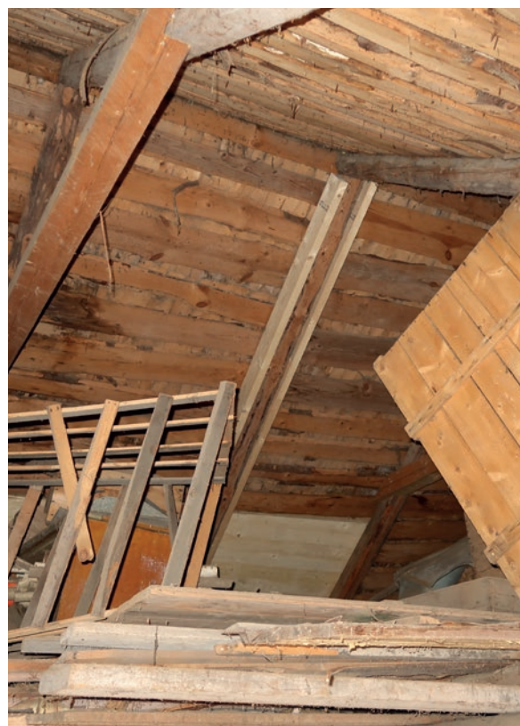
Den rötskadade sparren förstärktes med hjälp av träreglar på båda sidorna.
