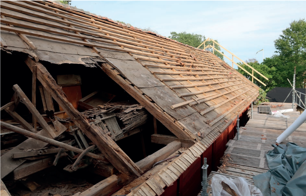
Ladugårdens södra takfall efter nedplockning av tegelpannor. En större skada upptäcktes i den västra delen. Här hade långvarigt läckage och dåligt fungerande masoniteunderlag givit rötskador i både takstolens sparre och hammarbandet.
