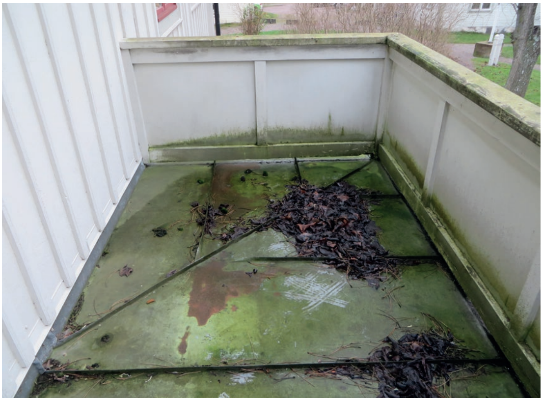
Balkongens golv före åtgärd. Balkongen saknade ett ordentligt golv och plåttaket hade algpåväxt.
