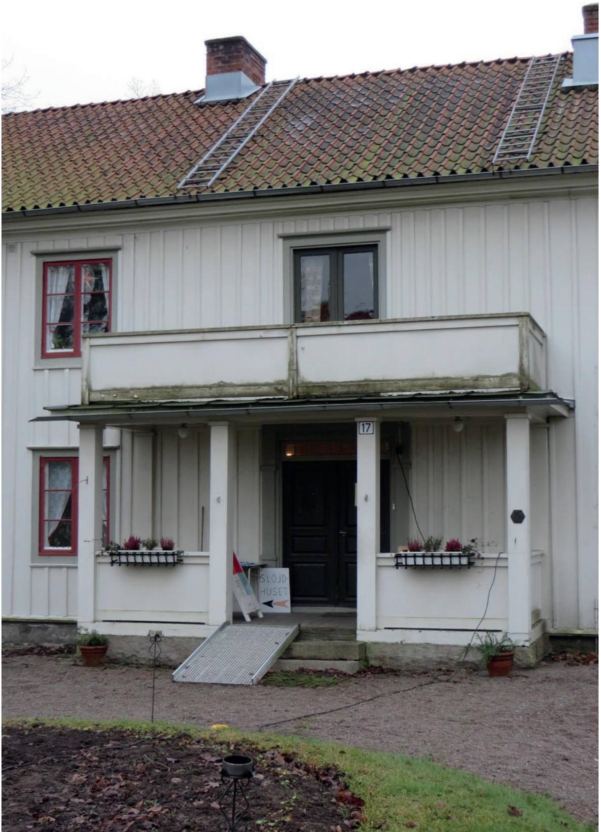
Balkongräcket på Olssonska gården före åtgärd.
