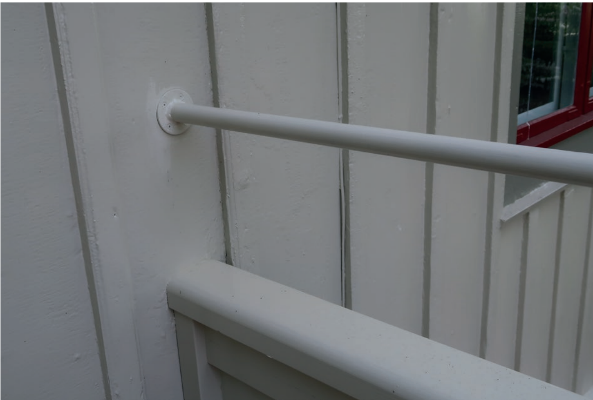
Balkongräcket efter åtgärd. Det nya balkongräcket fästes, förutom i det gamla räcket, också i huvudbyggnadens fasad.
