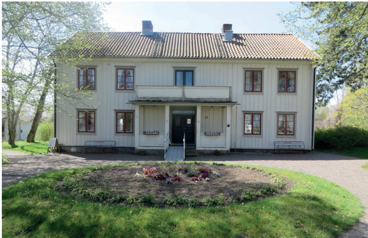
Olssonska gårdens norra fasad före åtgärd. Balkongräcket har påväxt och är i behov av renovering.
