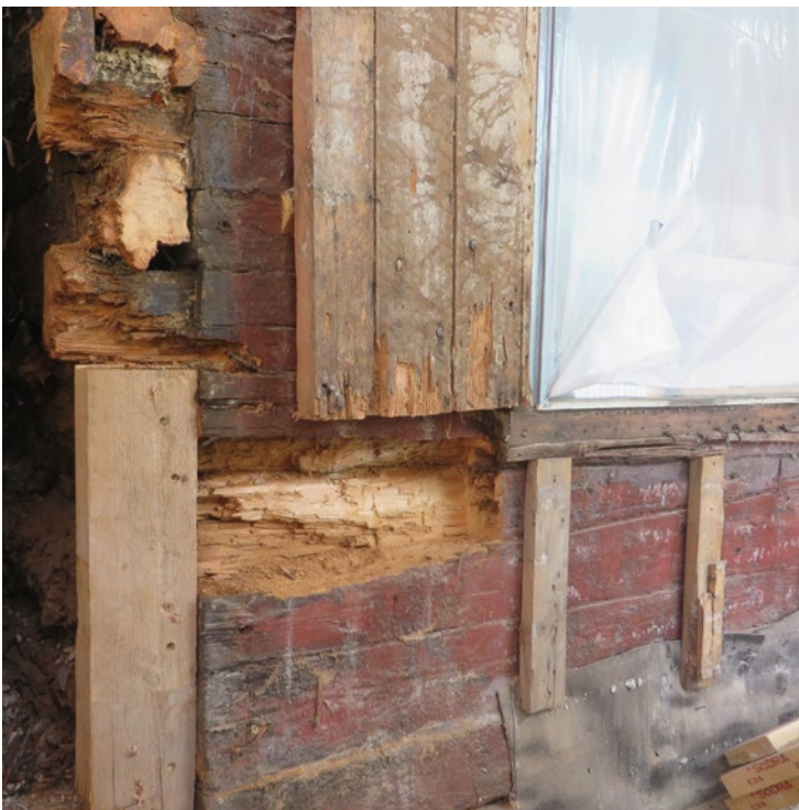
Skadan i husets östra del i samband med Anticimex provtagning.
