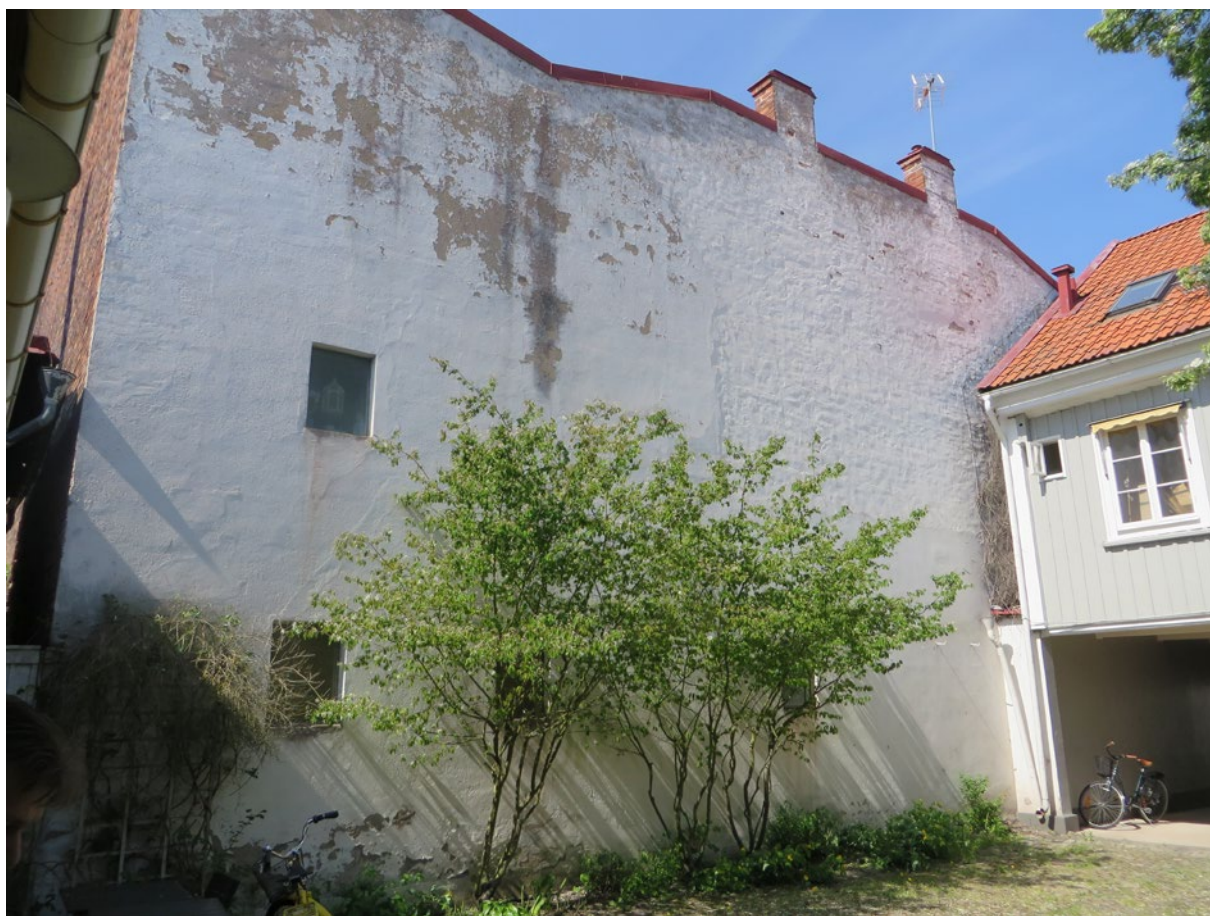
Gaveln inför arbetet med smutsad och sliten fasad.
