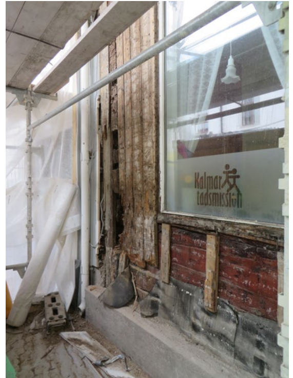
Skada i husets östra del, nertill.
