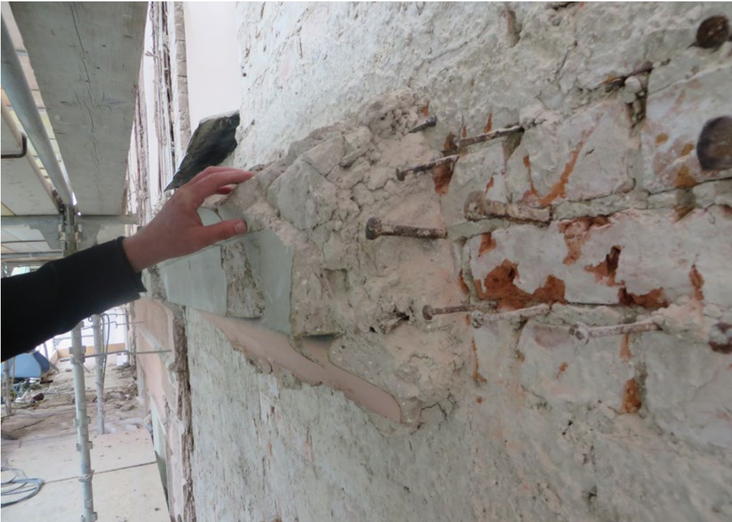
Detalj där man ser putsbärare för gördelgesimsen på tegelstommen vid rivning. Stora smidda spikar var underlaget och putsen var mycket tjock.
