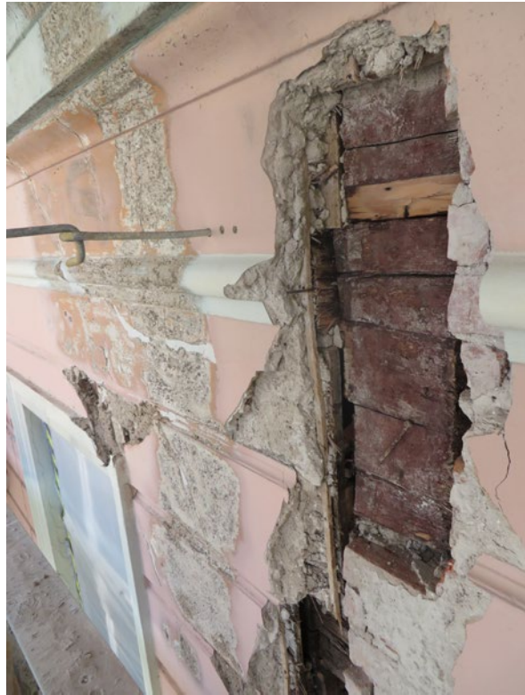
Undersökning inför rivning. Här syns spår efter test med bläster och en borthuggen del med skadad puts.
