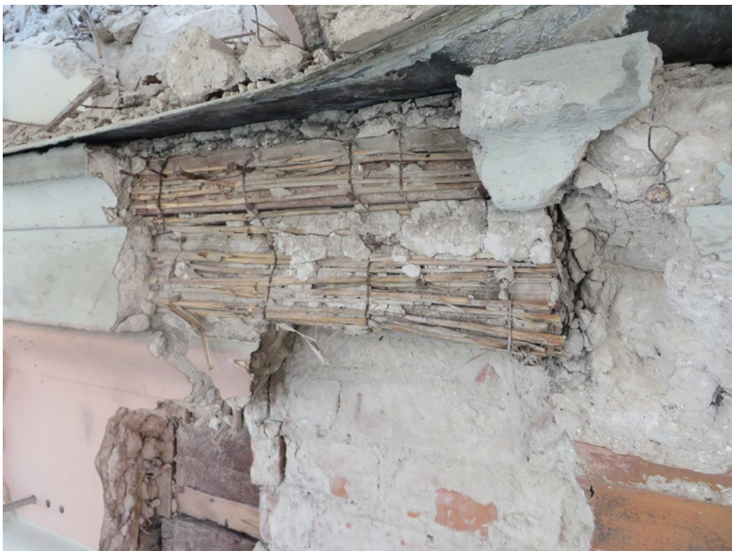
Skada i takfoten där man ser hur takfotens putsbärare är vass, spik och ståltråd.
