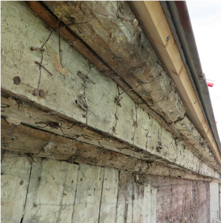
Detalj takfoten efter att putsen rivits.
