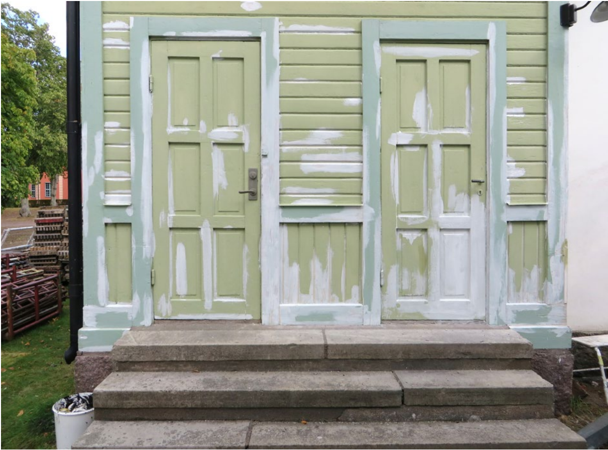
Fasad i väster där där ytorna är tvättade, skrapade, kittlagade och grundade. Grundning gjordes med en ljus linoljefärg som målarna hade hemma, i väntan på att bruten färg skulle levereras.
