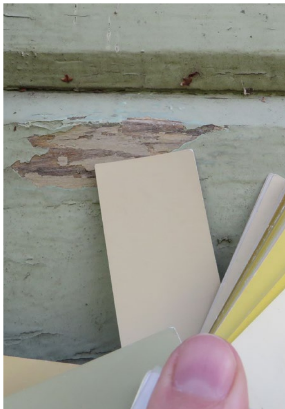
Understa färglagret som var mer beigt på fasadpanelen.
