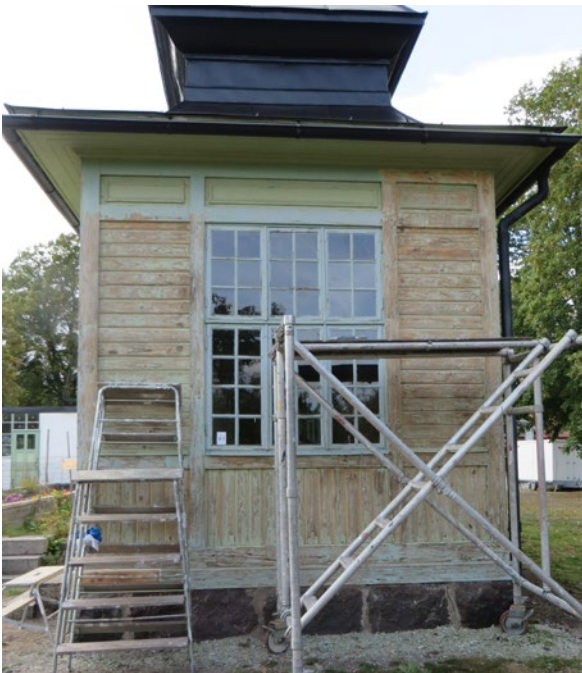
Fasad mot öster när större delen av panelen frilagts från färg med hjälp av Speedheater.
