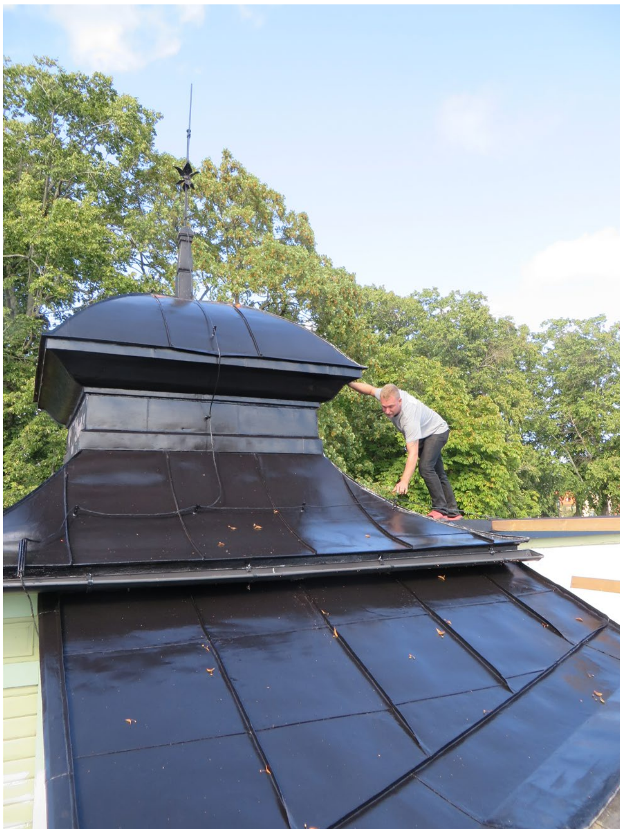
Plåtslagare Johan Stjernedahl inspekterar plåten på västra kupolen där målarna uppmärksammade vissa sprickor.
