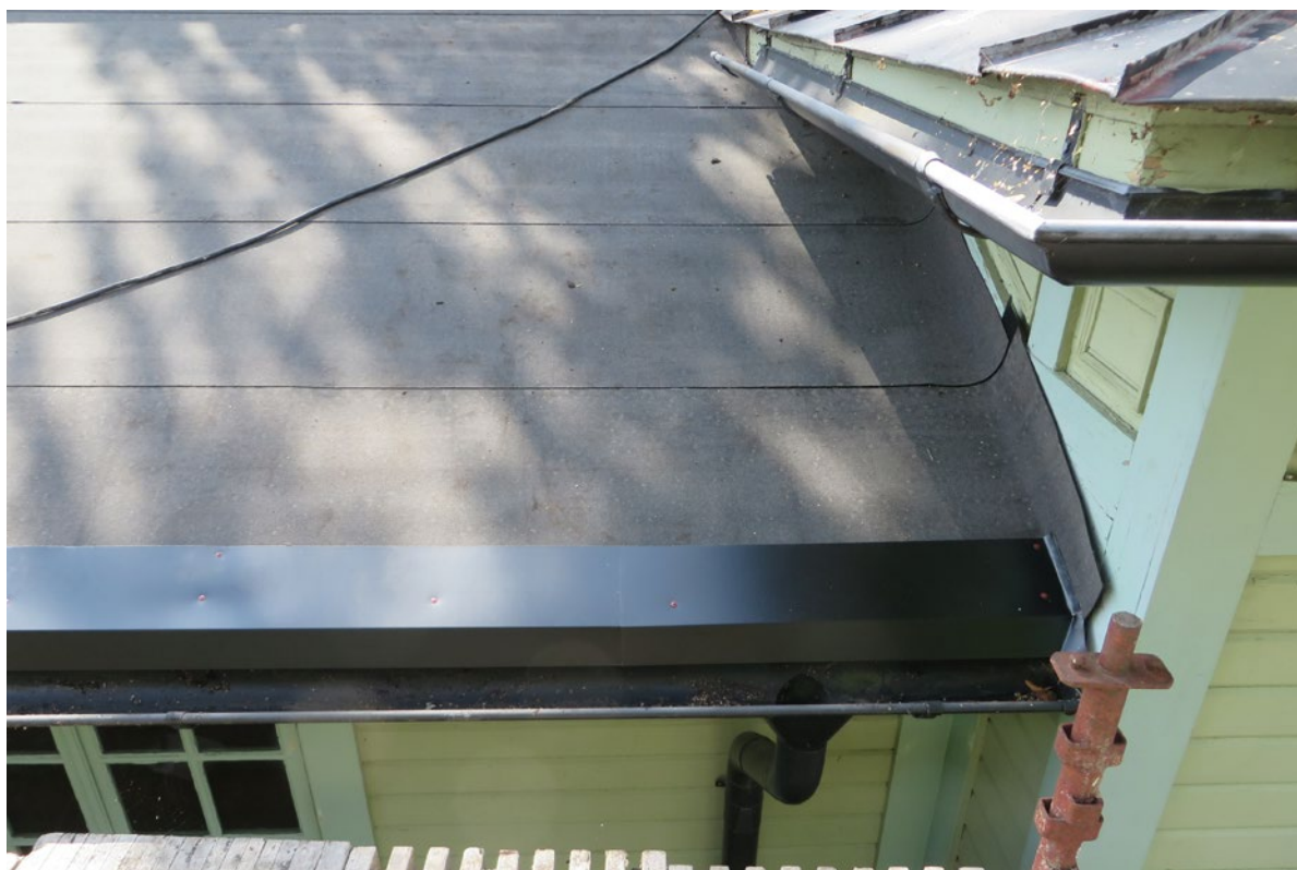
Det gamla papptaket har rivits och ny underlagspapp samt plåtbleck finns på plats.
