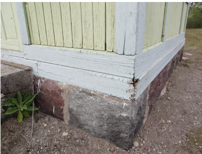
Hörnet i sydost där rötskador fanns i fasadens nedersta delar. Här tyckte målerientreprenören att mycket av virket skulle bytas ut. Dock byttes bara mindre delar, se vidare under avsnittet "Kommentarer".
