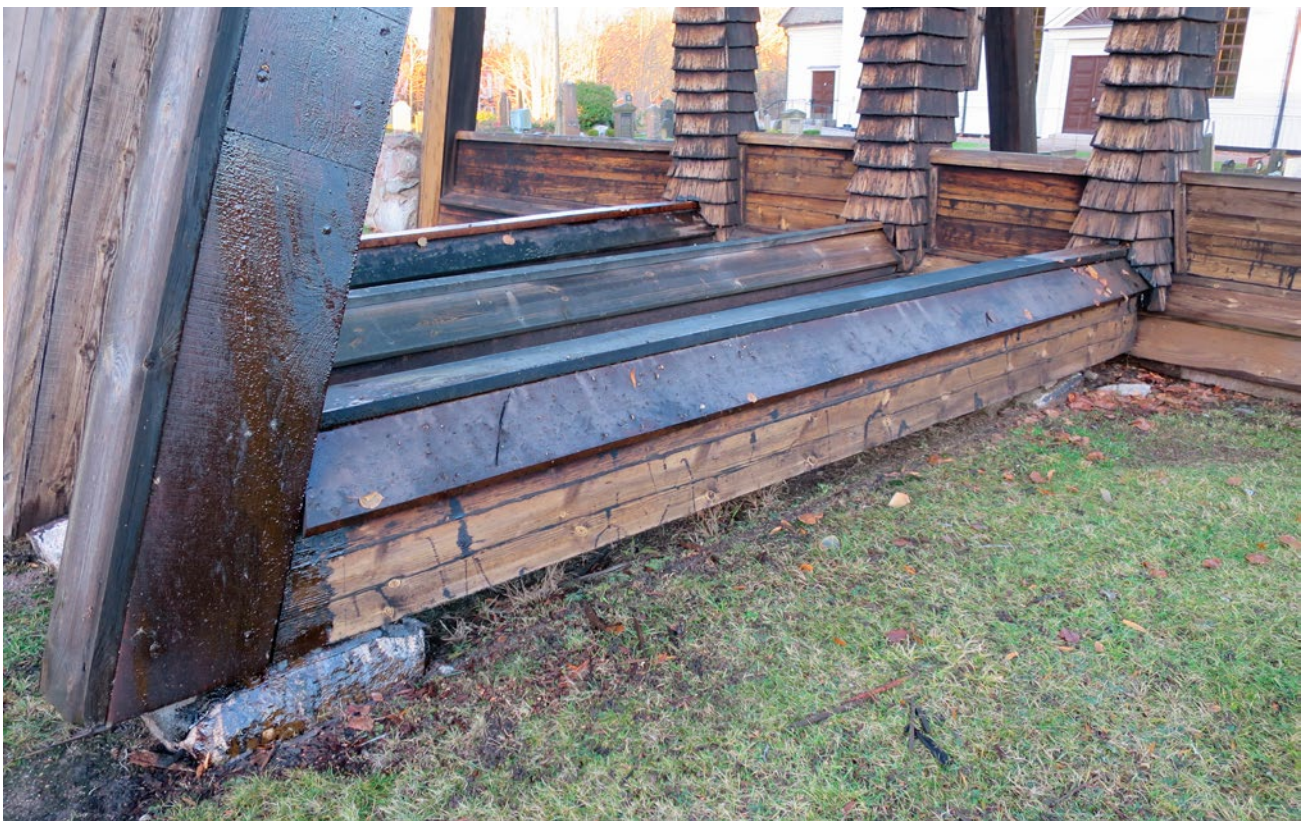
Utbytta täckbrädor på horisontella stödben och ilagning med friskt virke på stående stödben
