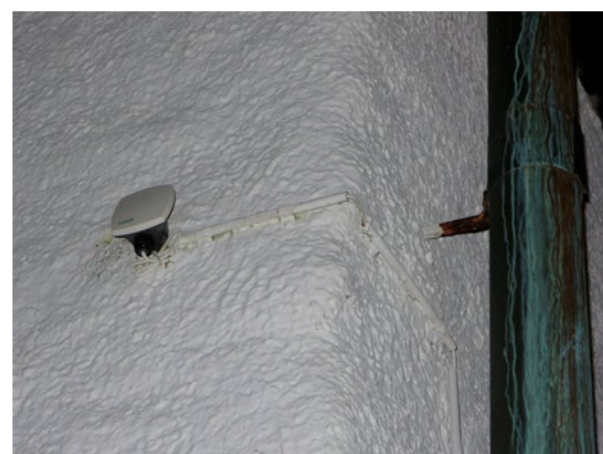
Den nya utegivaren på norra fasaden.
