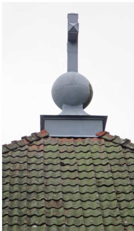
Korset före åtgärd.
