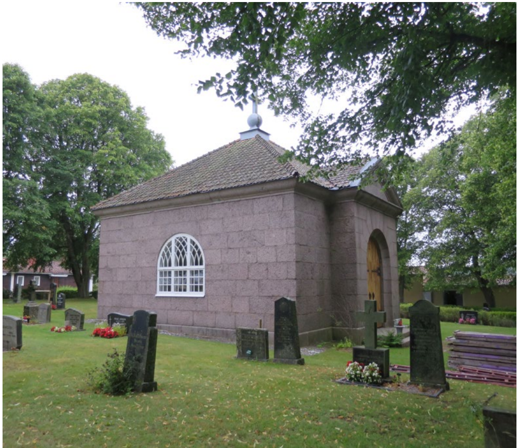
Gravkapellet före åtgärd.
