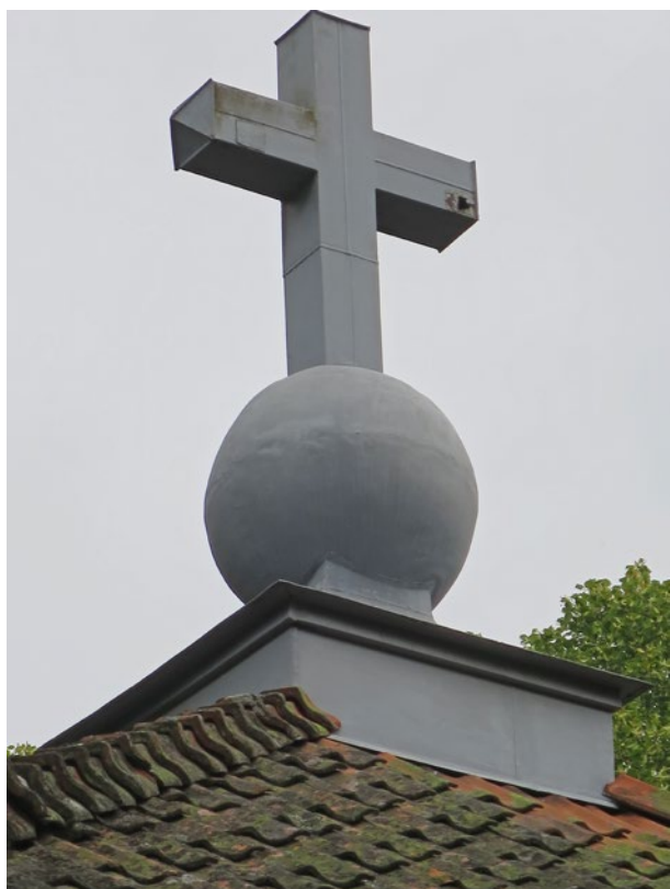
Korset före åtgärd.
