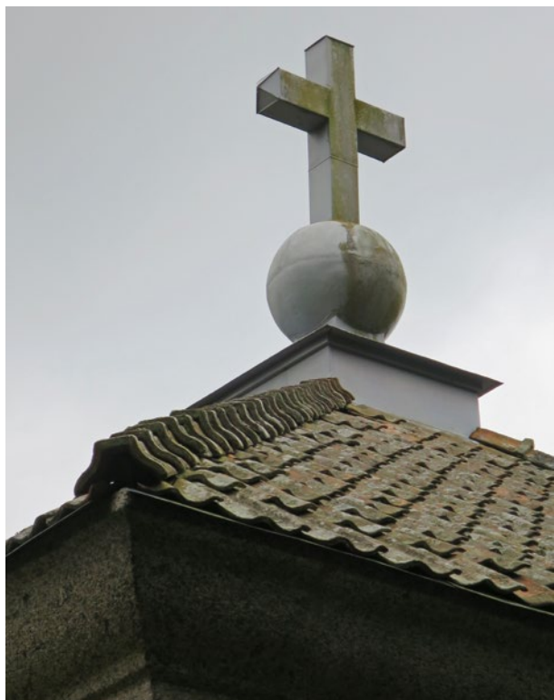
Korset före åtgärd. Kraftig algpåväxt.
