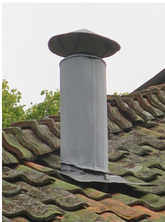
Numera borttagen ventilationshuv, före åtgärd.
