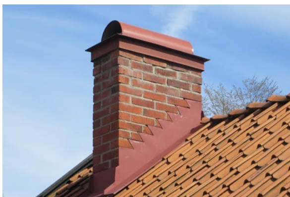
Skorsten med plåtskoning mot takteglet av äldre typ.
