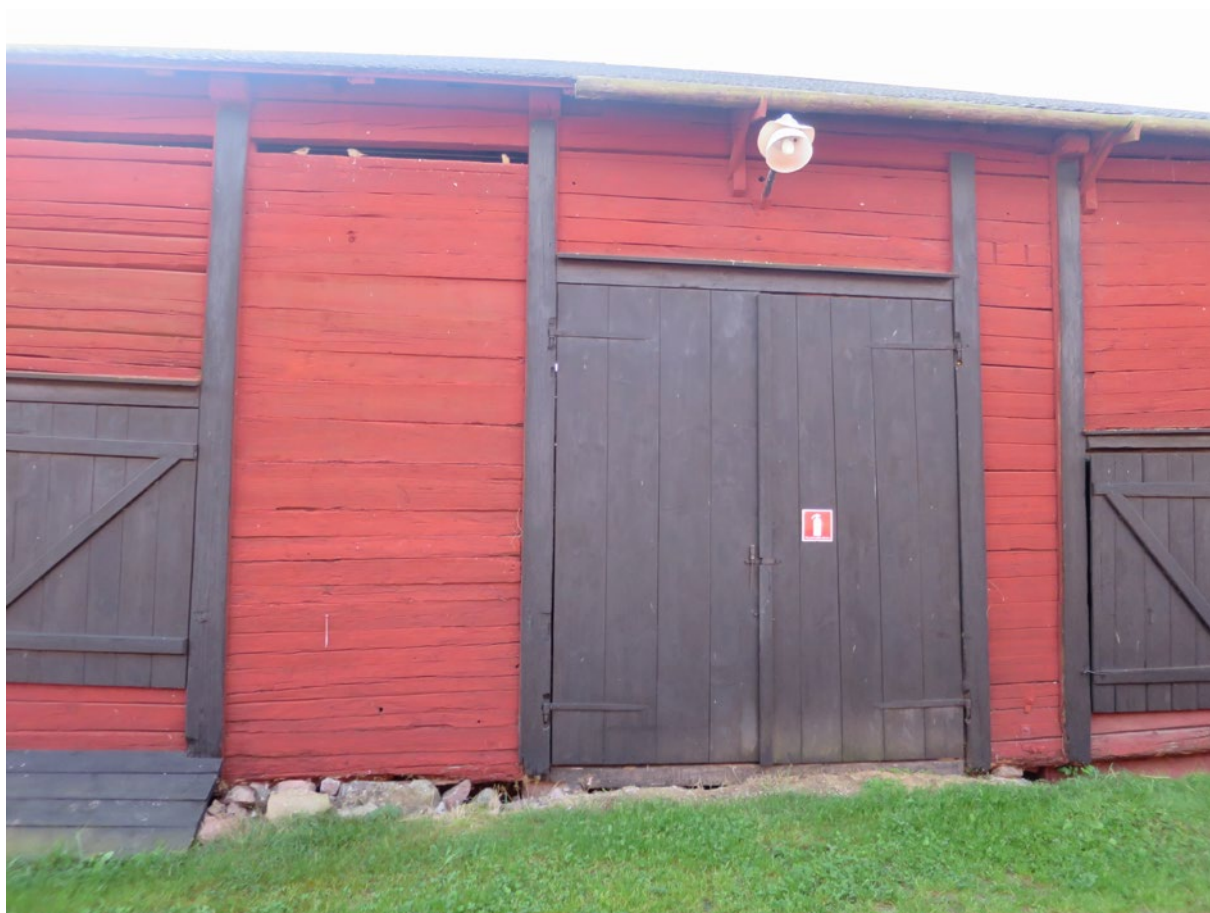
Skylt för brandsläckare.
