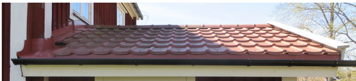
Tegelimiterande plåt, plegel, och plåtskoningar som går högt upp på den anslutande fasaden.
