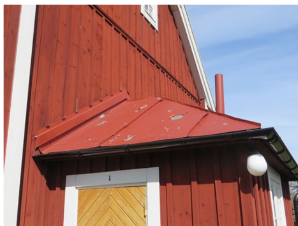
Fabriksmålad plåt med färgsläpp.
