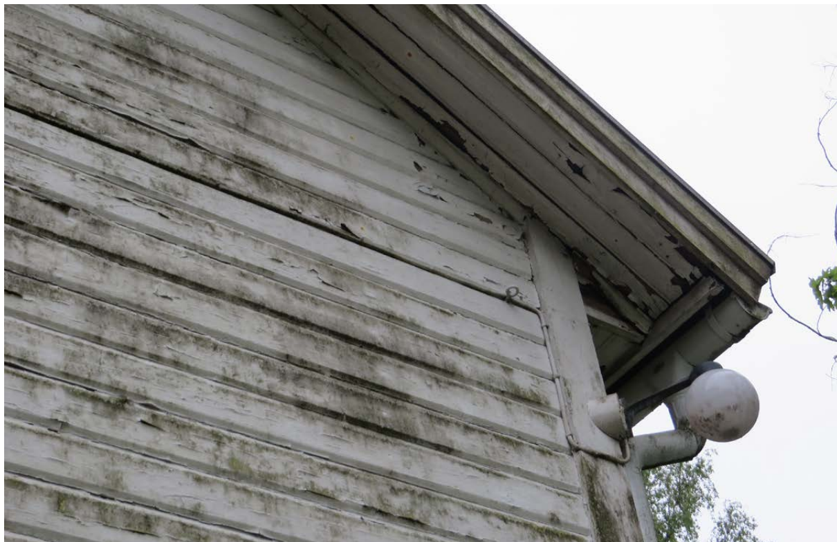
Underslaget på lågdelen i sydväst där det fanns skador.
