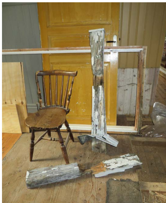
Nedplockat rötskadat kors bredvid stolen.
