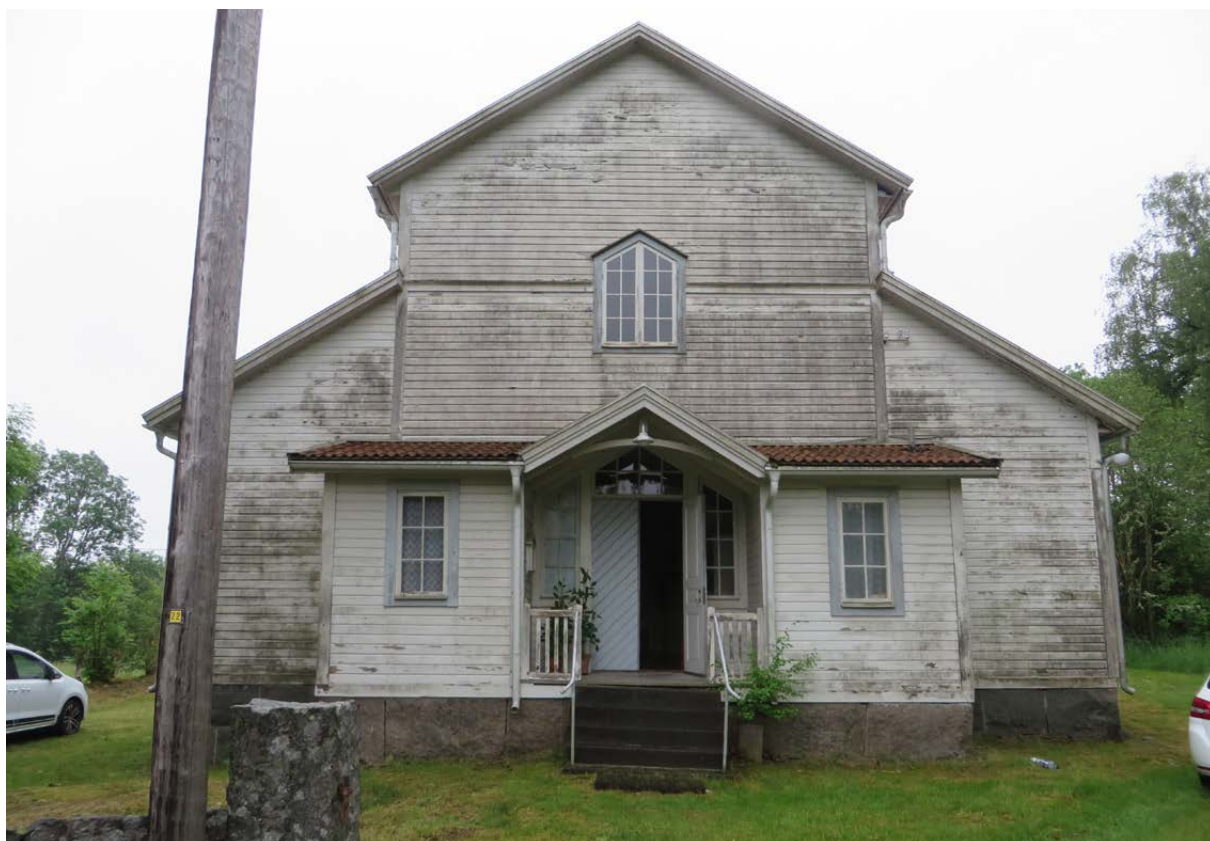
Västra fasaden inför ommålning.
