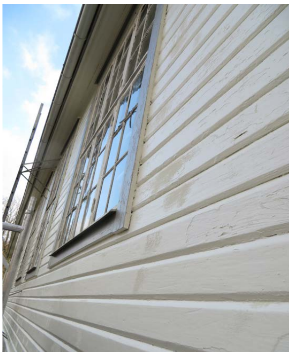
Detalj av norra fasaden där mattfläckar syns.
