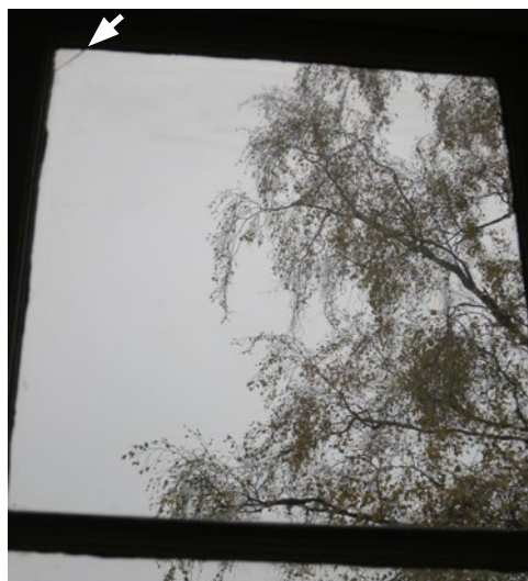
Sprickor i fönsterglas.
