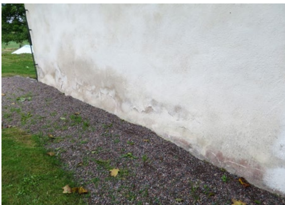
Dränering av Tveta kyrka före åtgärd. Fuktskador på sakristians västra vägg. (Foto: Ulrika Haraldsson)
