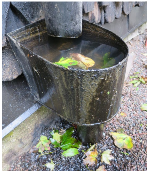
Dagvattenledningar Tveta kyrka före åtgärd. Anslutning från stuprör till dagvattenledning. Som synes är ledningarna igensatta och vattnet rinner inte ner. (Foto: Ulrika Haraldsson)
