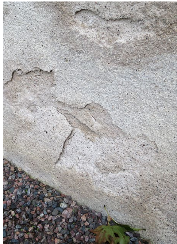
Dränering Tveta kyrka före åtgärd. Närbild på en av fuktskadorna på sakristians västra vägg. (Foto: Ulrika Haraldsson)
