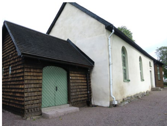
Dagvattenledningar Tveta kyrka före åtgärd. Vid vapenhus och långhus leder stuprören ner till dagvattenledningar under mark. (Foto: Ulrika Haraldsson)
