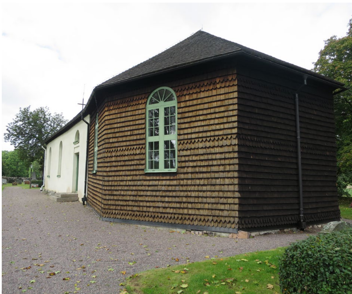
Tveta kyrka från sydost före åtgärd. Här syns tre av de befintliga stuprören som leder direkt ner till dagvattenledningarna under mark. (Foto: Ulrika Haraldsson)
