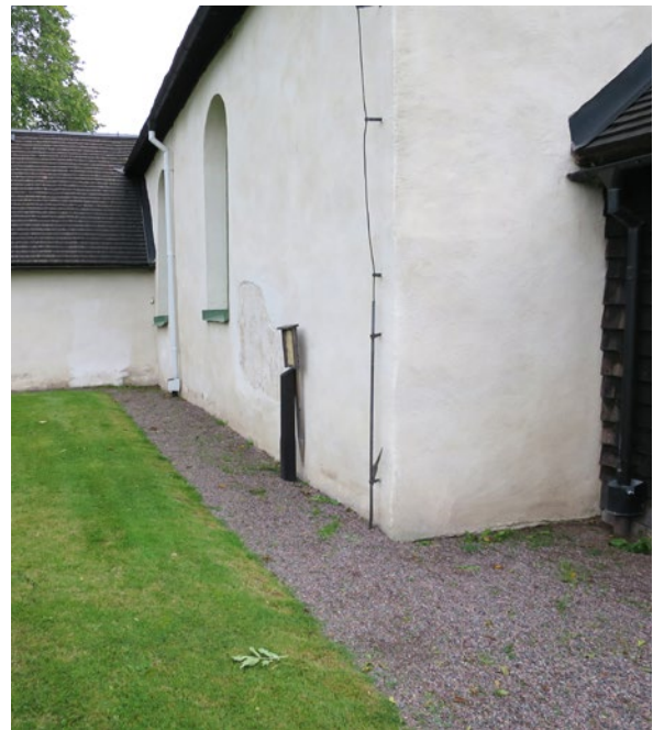
Norrsidan av Tveta kyrka före åtgärd. På sakristian till vänster i bild syns fuktproblem längs nedre delen av ytterväggen. (Foto: Ulrika Haraldsson)
