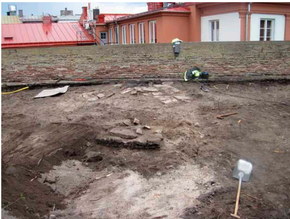
Fig 8. På sina ställen var det ett mycket tunt matjordställe och de övre delarna av valvkonstruktionerna blev snabbt synliga.
