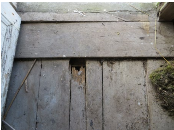
Rötskador i golvet.
