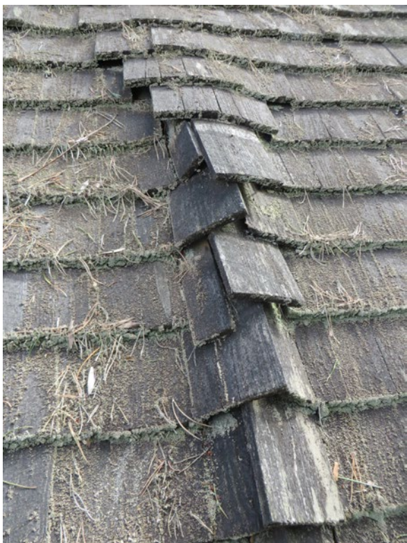
Spåntaket lades för tätt vid senaste omläggningen. När träet blir blött sväller det och reser sig från underlaget.
