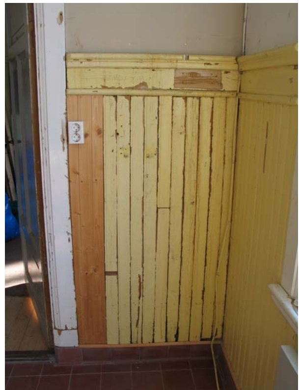
I samband med att denna vägg åtgärdades efter en vattenskada år 2005 upptäcktes en gammal vattenskada
