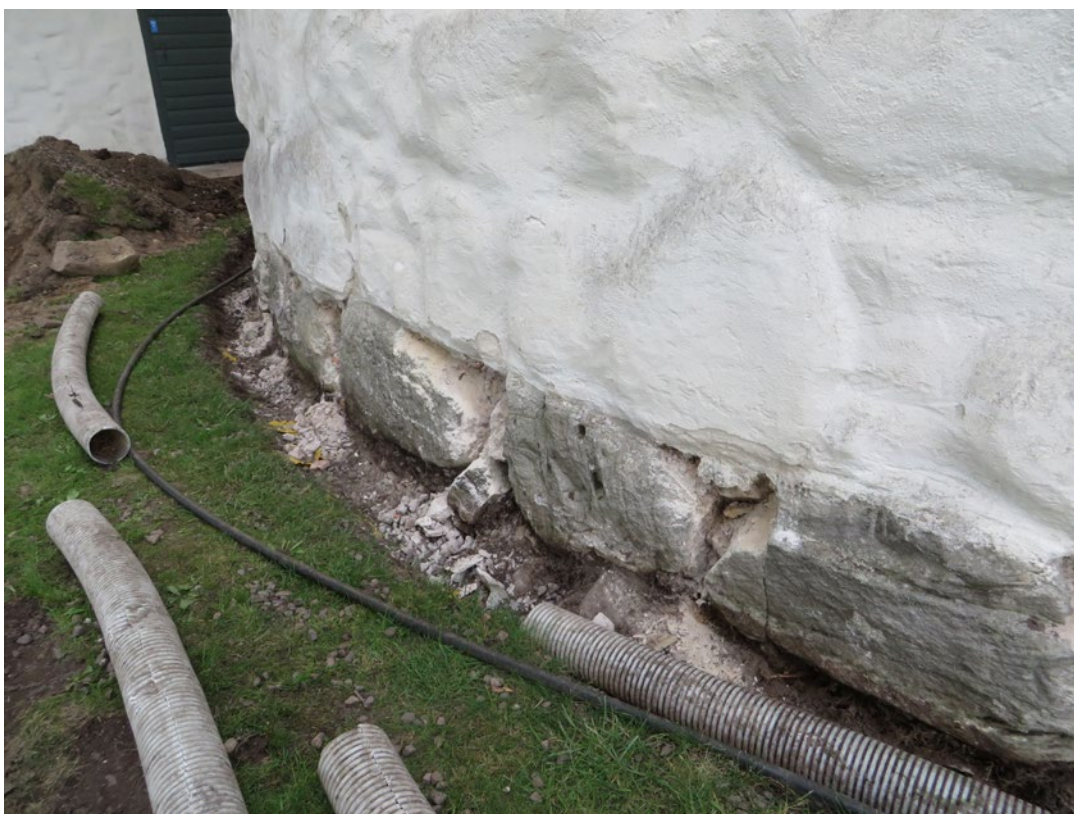
Kyrkans västra byggnadsdel mot söder. Stenfot som rengjorts och fått äldre fog borttagen inför omfogning.
