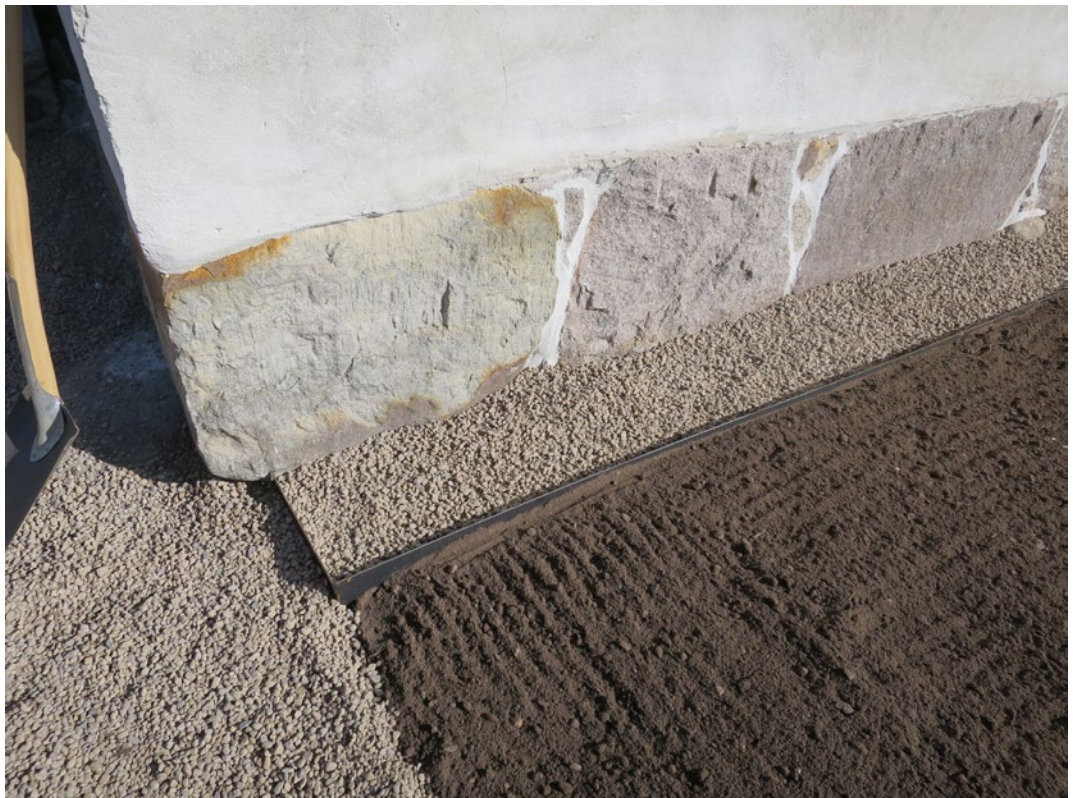
Detalj där man ser kortenstål och singel vid lagad stenfot. Vid kyrkan sydvästra hörn.
