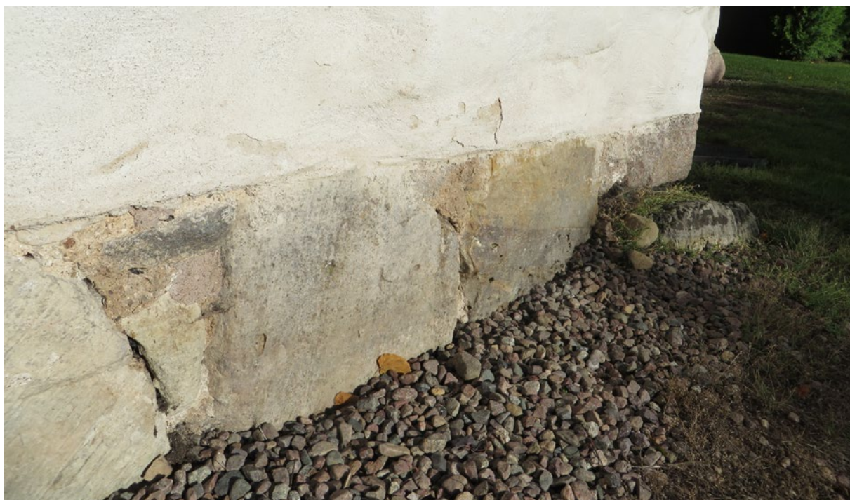
Del av östra fasaden med stenfoten som har lagningar och där fogbruk fallit bort inför arbetet.
