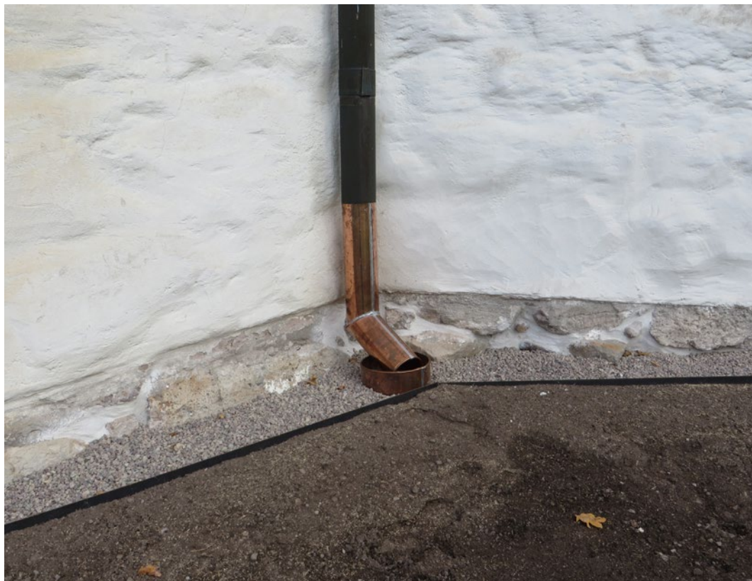
Detalj där man ser kompletterat stuprör och regnvattensbrunn vid rundhusets södra fasad.
