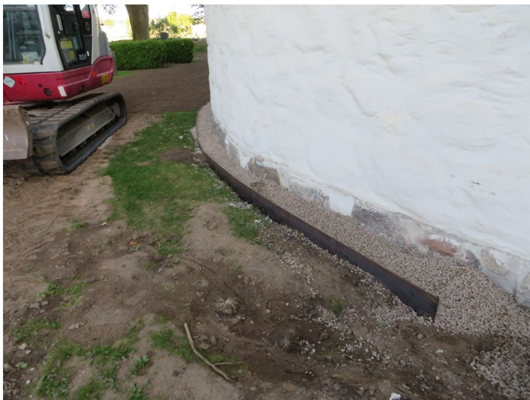
Kyrkans norra sida när stenfoten lagats, kortenstål och singel lagts intill fasaden och marken är återställd.
