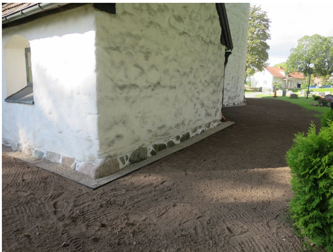
Här pågår montering av kortenstål vid rundhusets norra fasad samt uppfyllnad med singel intill stenfoten. Stenfoten är nu upplagd.
