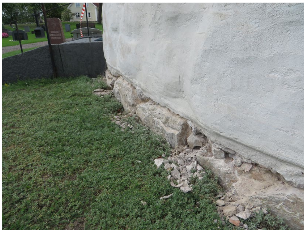
Rundhuset i söder när äldre fogar tagits bort och sten fallit ut. Stenen återanvändes sedan vid omfogningen.
