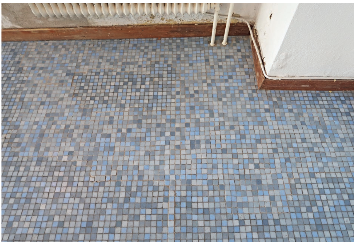
Närbild av lagningen i det sydvästra hörnet av övervåningens foajé. Ersättningsmosaiken har en något ljusare nyans än mosaiken hos kvarvarande orörda ytor.
