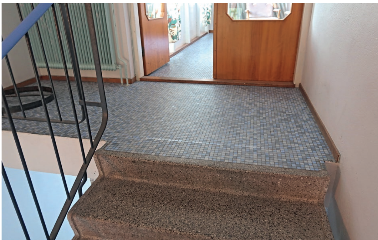
Sprickan mellan trappan och bjälklaget har fyllts i med nya glasmosaikbitar.
