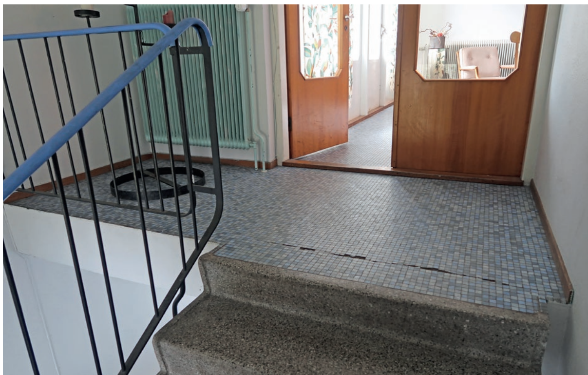
Skada som uppstått vid skarven mellan den prefabricerade trappan och övervåningens bjälklag.
