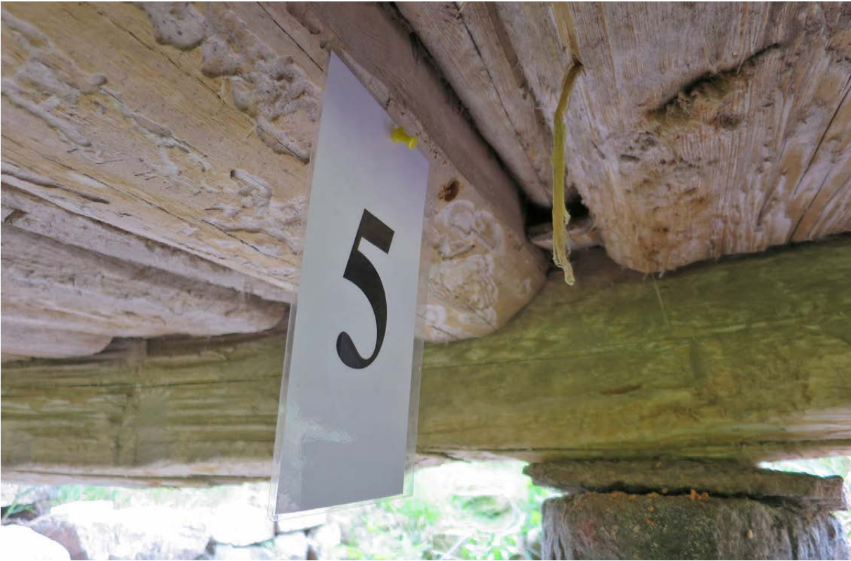
Virket till golvbjälklag och syll i byggnad 3 är något yngre än bottenvåningens ytterväggar. Prov nr 5 daterades till 1681 \pm 4 år. En samtida mellanvägg på bottenvåningen fick en mer exakt datering till vinterhalvåret 1686/87.
