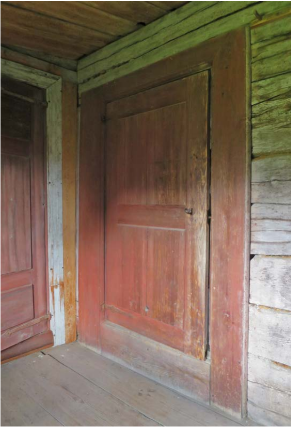
Dörren mellan trapphuset (rum 9) och kammaren (rum 8) på övervåningen i byggnad 7 fotograferad från trapphuset. Kammarens dörr är konstruerad på samma sätt som den intilliggande dörren mot "Rosa rummet", men är bara indelad i två spegelfält.
