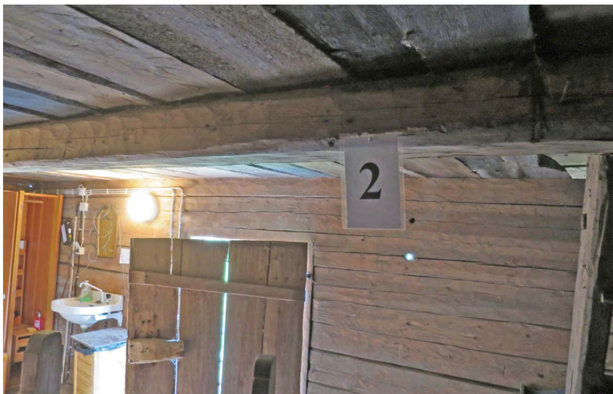
Prov nr 2 i byggnad 2, loftbod. Provet togs i en av mellanbjälklagets balkar. Analysen visade att tallen fällts vinterhalvåret 1793/94.
