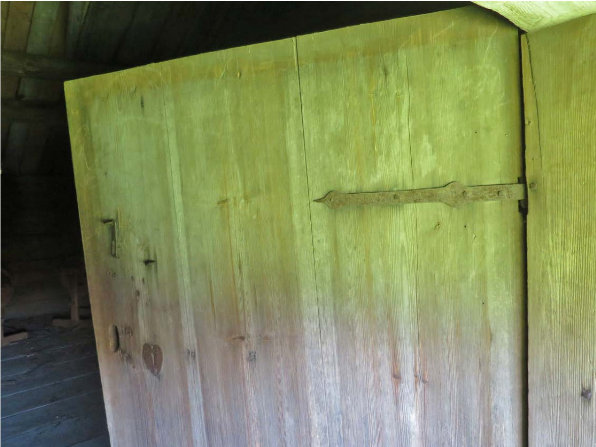
Närbild av utsidan på övervåningens vänstra dörr (åt sydväst). Gångjärnen har samma utformning på byggnadens alla dörrar.
