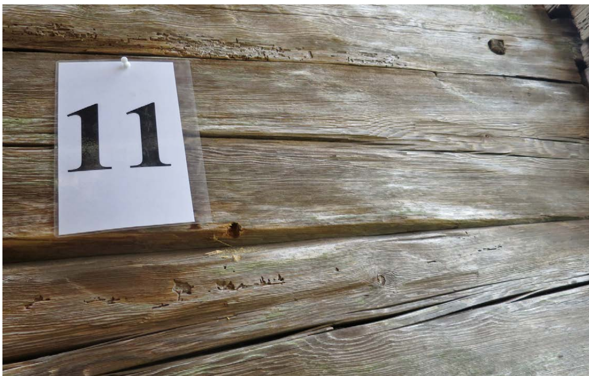
Prov nr 11 i byggnad 3 togs i den nedre delen av fasaden mot nordost, från det trånga utrymmet mellan byggnad 3 och 4. Analysen visade att timret fällts under vinterhalvåret 1671/72.
