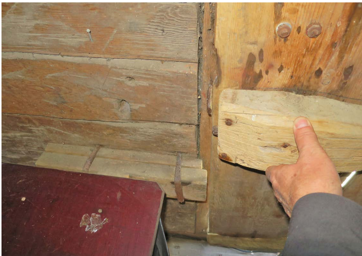
Närbild av dörrens båda primitiva låsanordningar. Lägg märke till det hål som finns i väggen någon decimeter över regellåset.
