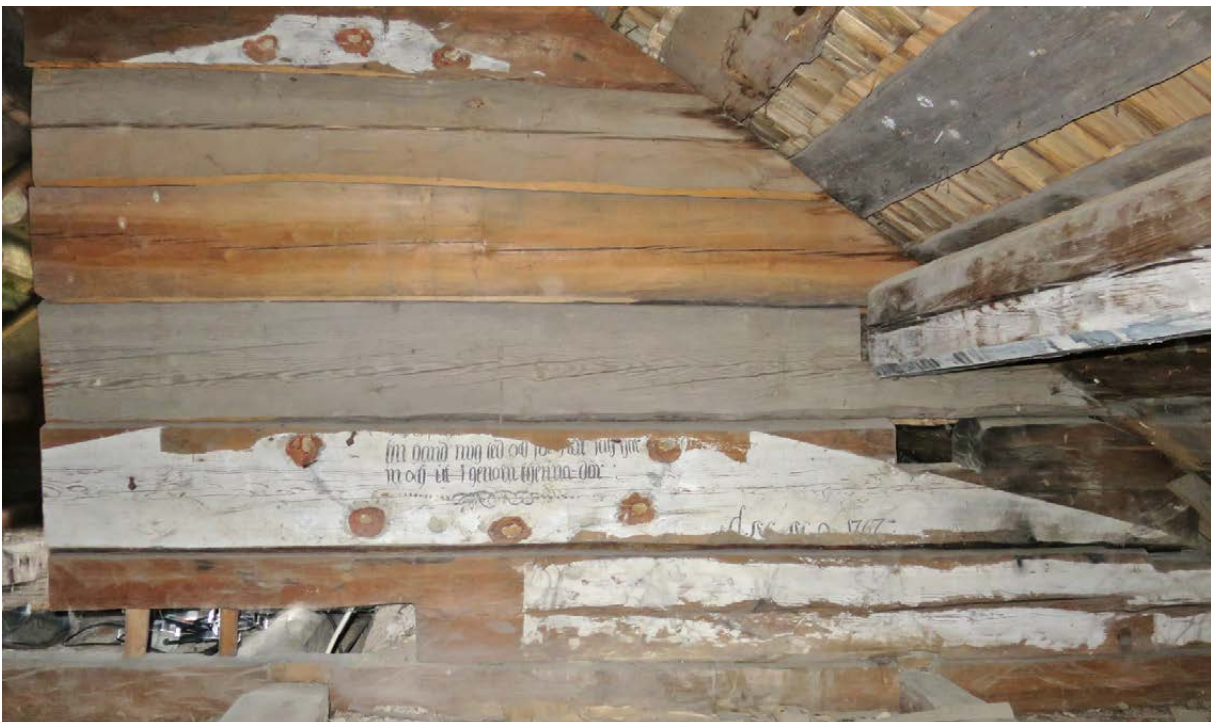
Mellanvägg på vinden i byggnad 6. Fotografi mot nordost. Väggens är uppförd av virke från olika tider. På en av de dekormålade stockarna syns året 1767.
