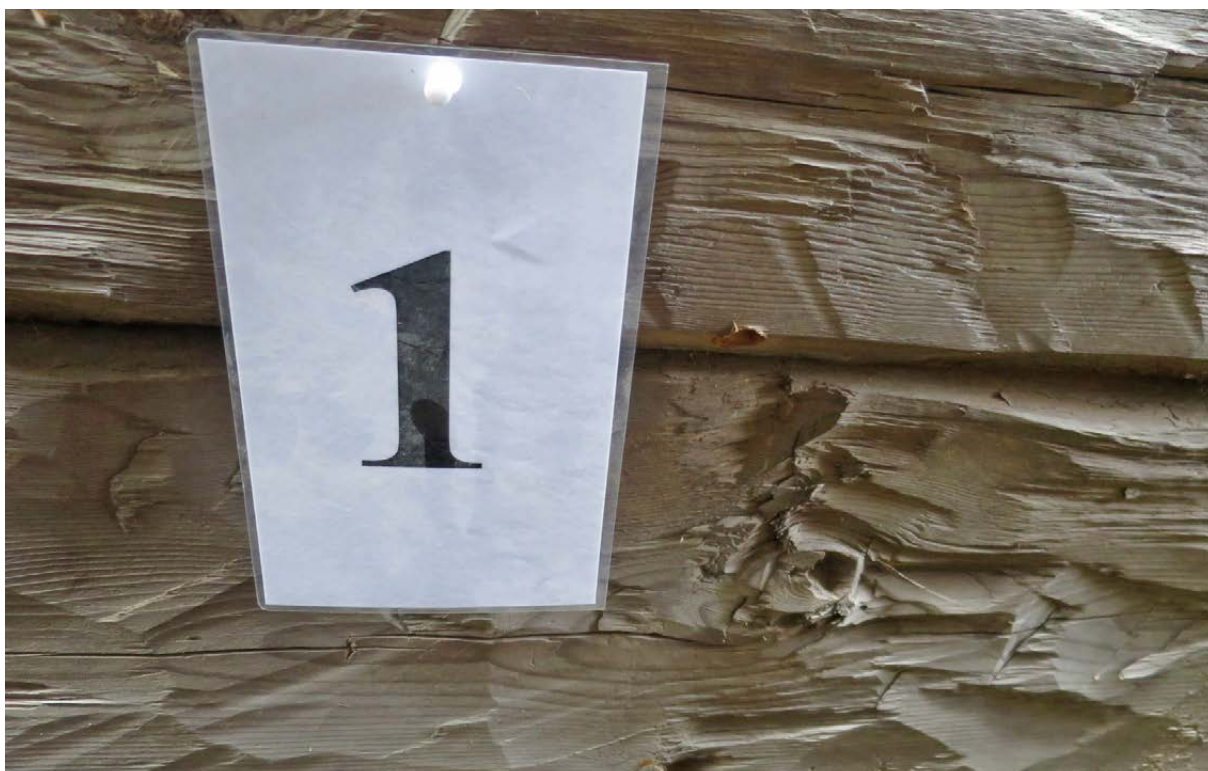
Borrprov taget i nedre delen av gavelväggen mot sydväst. Analysen visade att timret fällts under vinterhalvåret 1766/67. Hos byggnad 4 har timret inne i prånget mellan gavlarna en mindre bearbetad yta än hos byggnad 3. Se även fotografier på sidorna 34 och 35.
