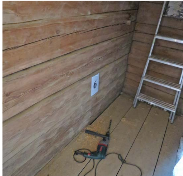
Prov 6 togs i ytterväggen mot nordost i ett förråd på övervåningen i byggnad 7. Provet har daterats till perioden 1790-1820, vilket normalt tolkas som att trädet tidigast kan ha avverkats 1790. I rapporten från laboratoriet som utfört analysen menar man ändå att det kan ha avverkats några år tidigare.
