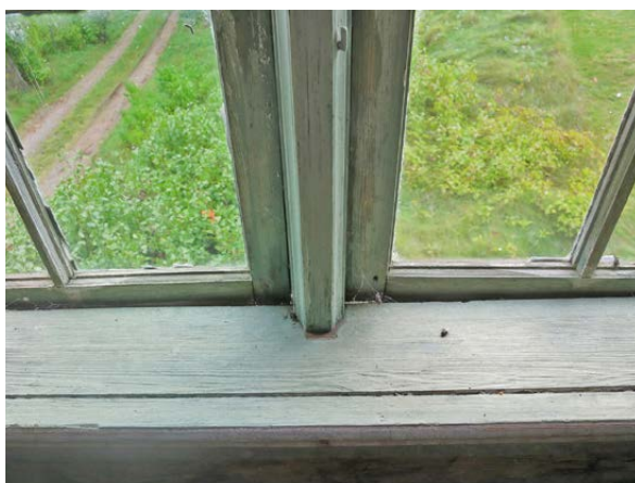
Fönsterpost i "Barockrummet", rum 1. Fönsterposten har störst likhet med typer som daterats till 1700-talets förra hälft. Samma profilering återkommer på flera andra fönster i huset, bland annat i det "Gustavianska rummet", rum 4.
