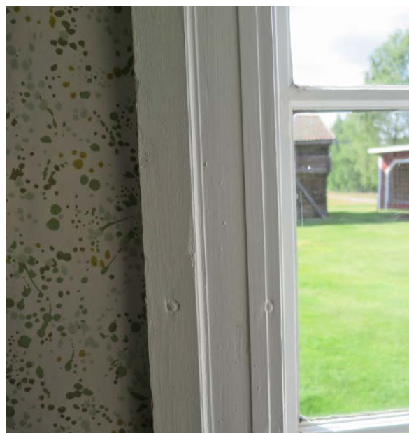
Fönsterfoder i rum 112 på bottenvåningen i byggnad 6. Samma eller liknande foder används till nästan alla fönster i byggnad 5 och 6.
