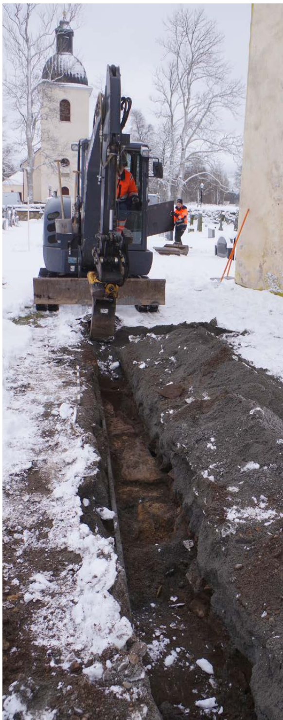
Figur 19. I schaktet som gick genom det gamla koret påträffades spår av en gravkonstruktion, förmodligen herrgården Drättinges gravvalv. Foto taget från norr.
