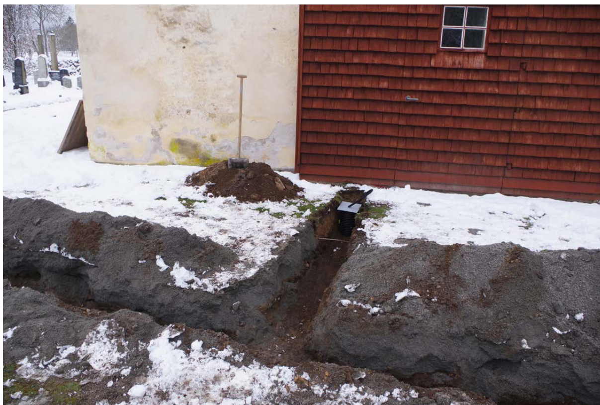
Figur 9. Schakt 3 var ett kort anslutningsschakt som togs upp mot kyrkans östra gavel. Foto taget från öster.
