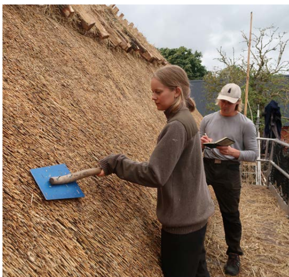
Elever från Capellagårdens byggnadsvårdsutbildning bidrog vid omläggning av stråtak på ett av husen på Ölands museum Himmelsberga.
