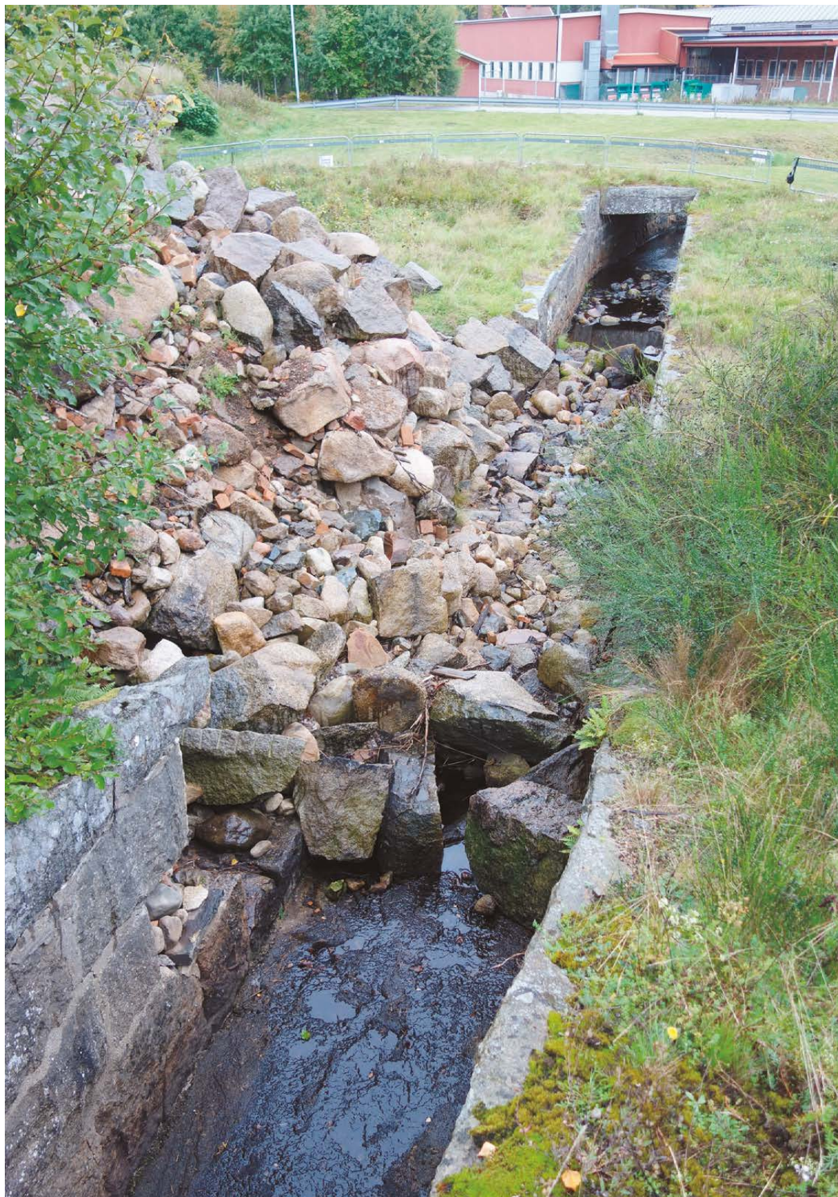
Raset påverkade kanalens kanter i relativt stor omfattning då det slog ned stenarna i kanalen.
