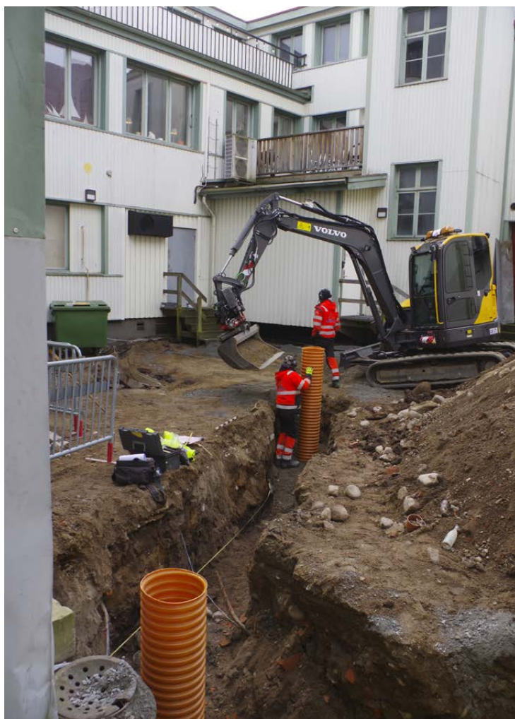
Figur 6. Schaktningen på innergården fick göras i omgångar eftersom det var trångt. Schakt 3 och 4 sett från nordöst.
