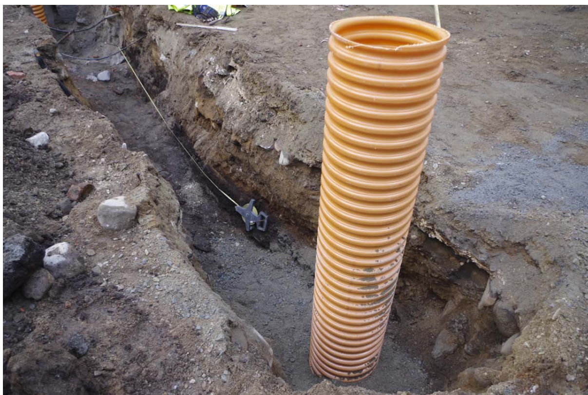
Figur 12. Kulturlager A5 i botten av schakt 3 och 4 under pågående ledningsarbete. Foto taget från väster.
