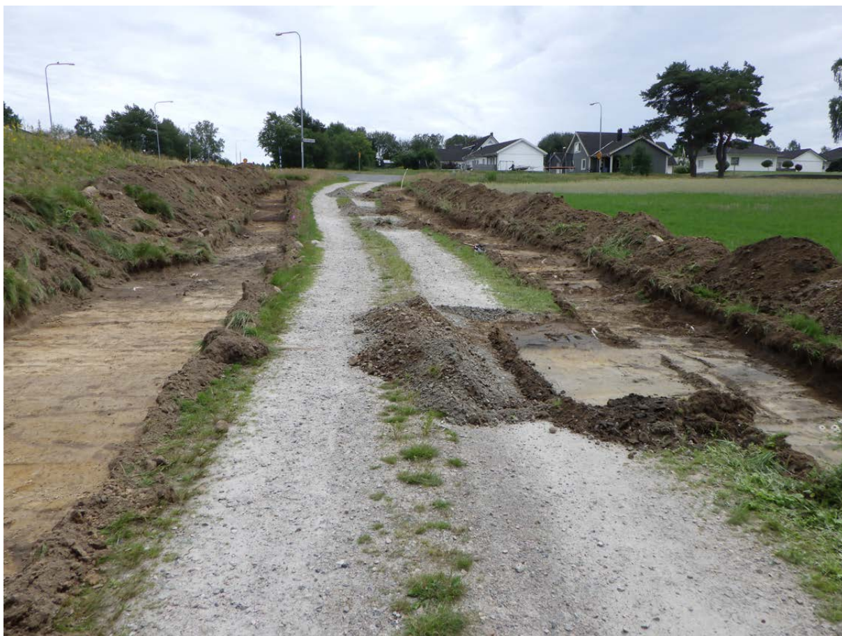
Figur 3. Pågående arbete med schaktning vid och under den befintliga grusvägen vid boplatsen L1954:8528. På fotot framgår vidare slutningen ner mot ån. Foto från väster.
