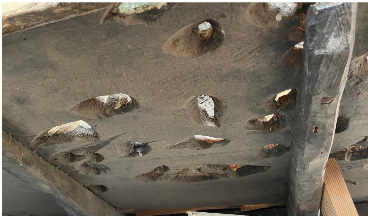
Smutsig baksida före åtgärd, detalj.
