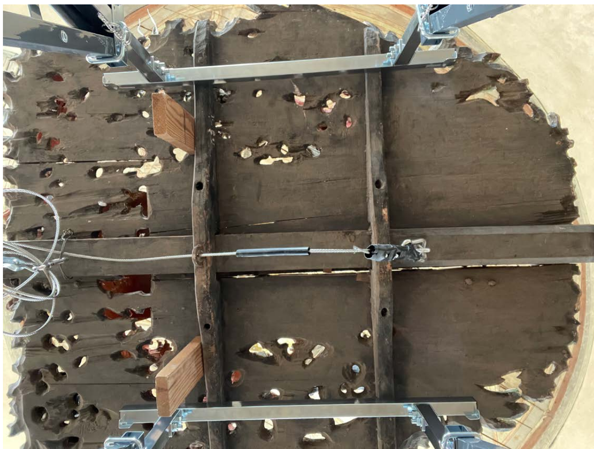
Smutsig baksida före åtgärd.
