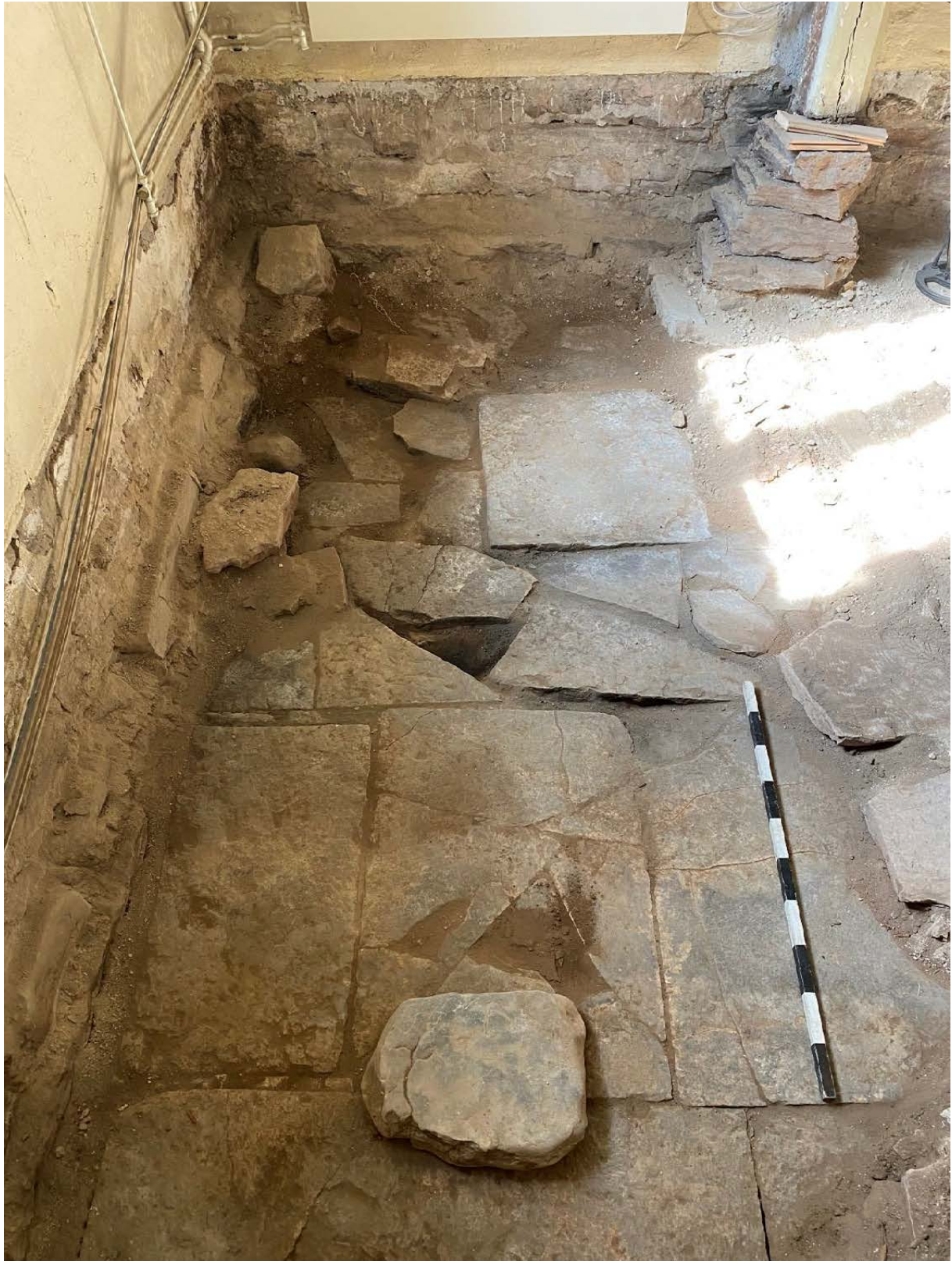
Figur 7. Det påträffade kalkstensgolvet var i stort sett intakt med några få skador i den SV delen. Foto från SO.
