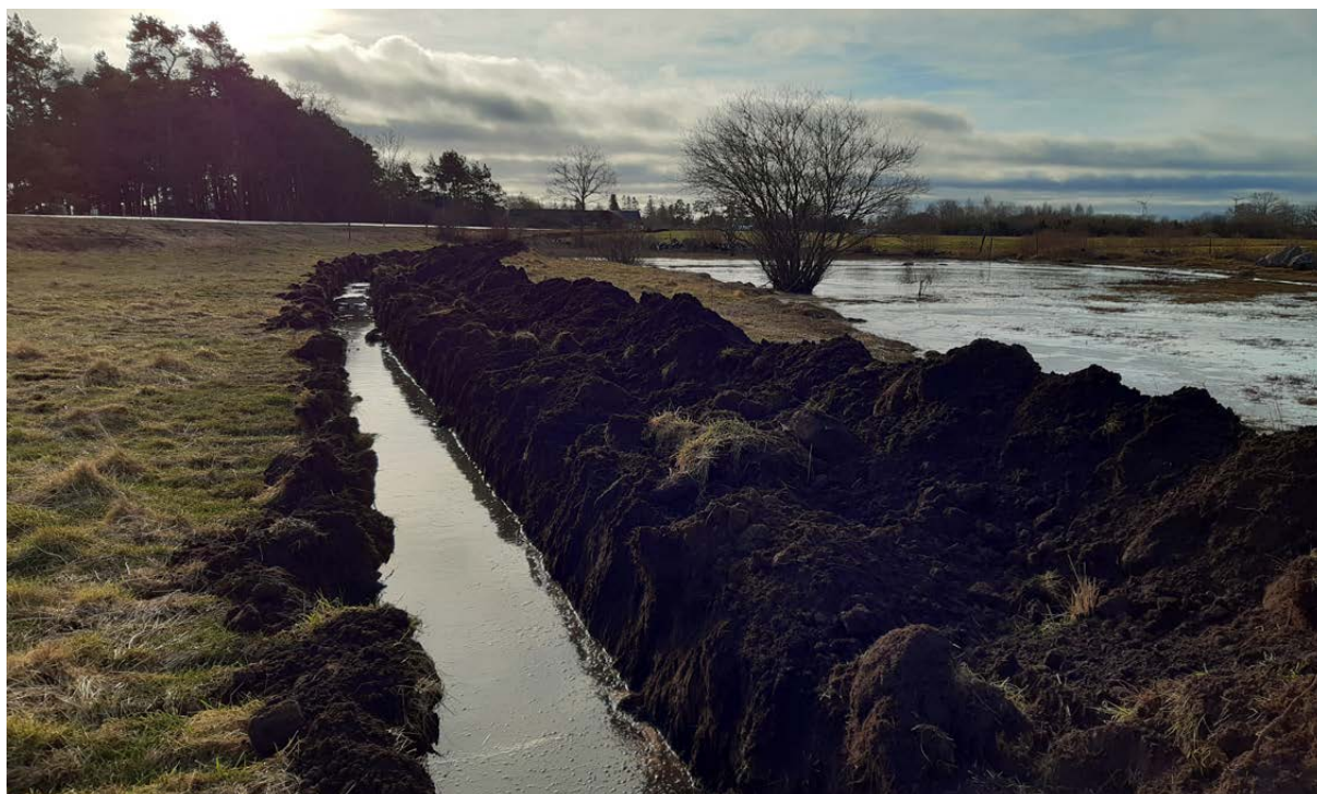
Figur 6. Schakten vattenfylldes snabbt av vatten som trängde upp underifrån. Foto från norr.
